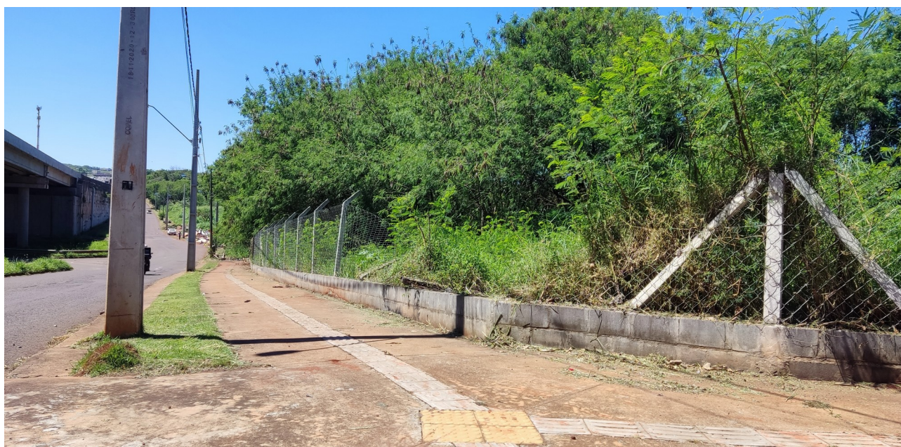
Imagem 05 – Cercamento danificado – Marginal do Contorno Norte com a Rua Pion. Bruno Blutgen
