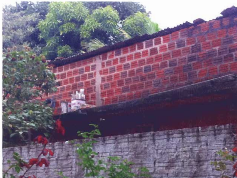
Foto 12: Lixo acumulado no beiral da laje da residência
