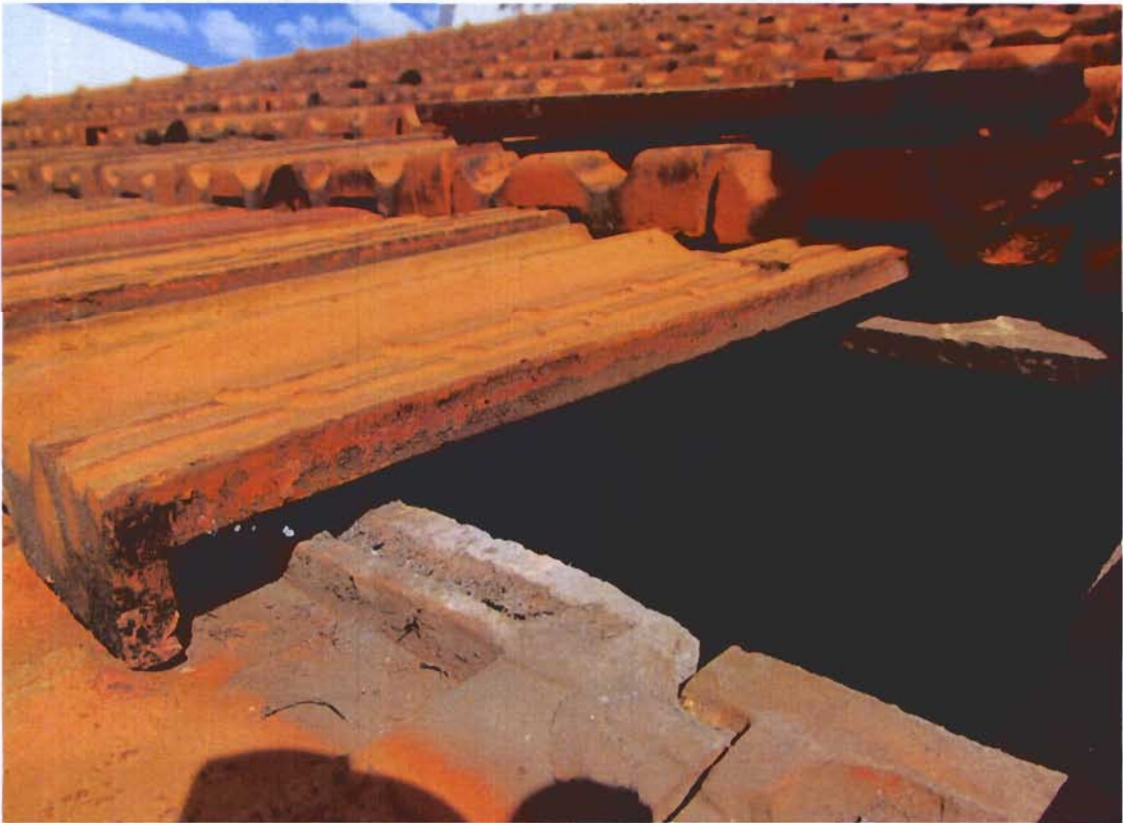
* telhado em péssimas condições.
