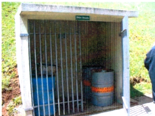
Foto 41: Cabine de armazenamento de óleo lubrificante usado, estopas e materiais têxteis contaminados com óleo e ou graxas lubrificantes.
