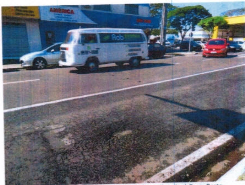
Foto 01 - Buraco na pista proximidade ao Terminal Ouro Preto
