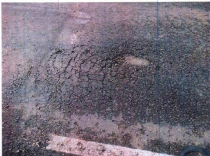
Foto 02 - Buraco na pista proximidade ao Terminal Ouro Preto
