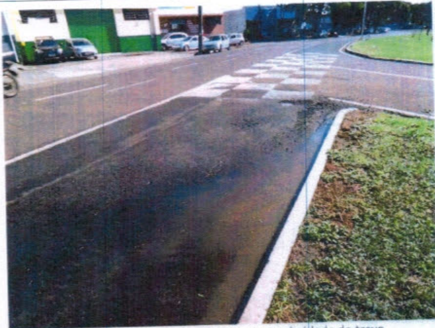
Foto 04 –Empoçamento e buraco na proximidade do trevo
