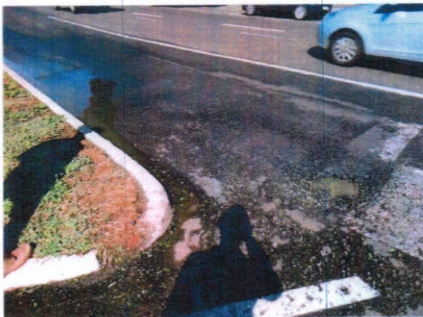
Foto 03 – Buraco na proximidade do trevo
