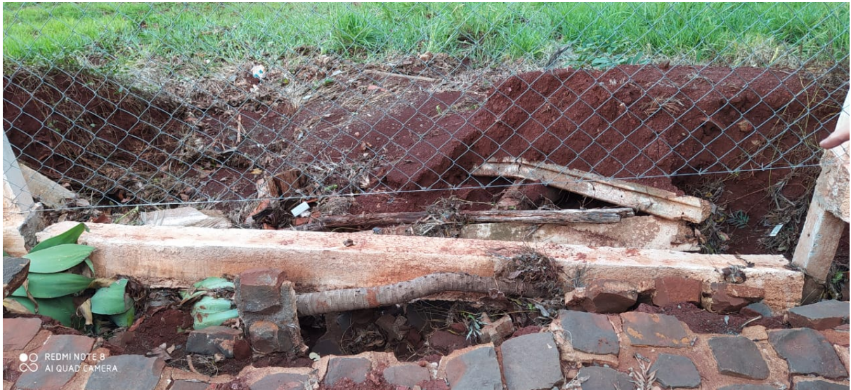
Figura 1. Danos causados por falta de vazão correta de precipitações.
