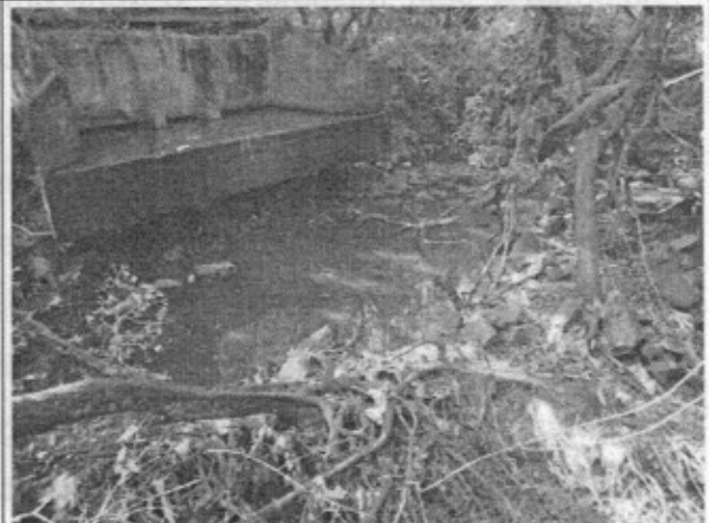
Foto 04 – Vista de dissipador com águas escuras.
