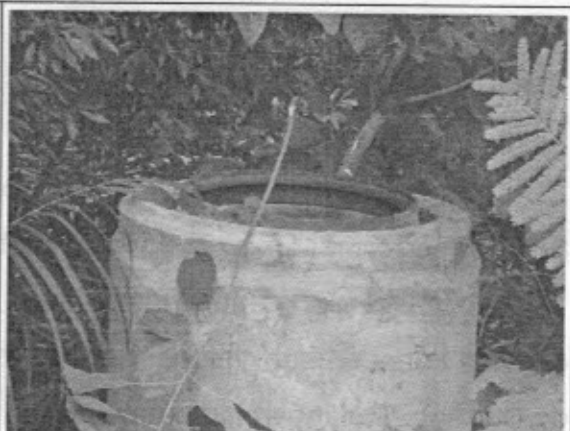
Foto 04: Vista do poço de vistoria sem tampa.
