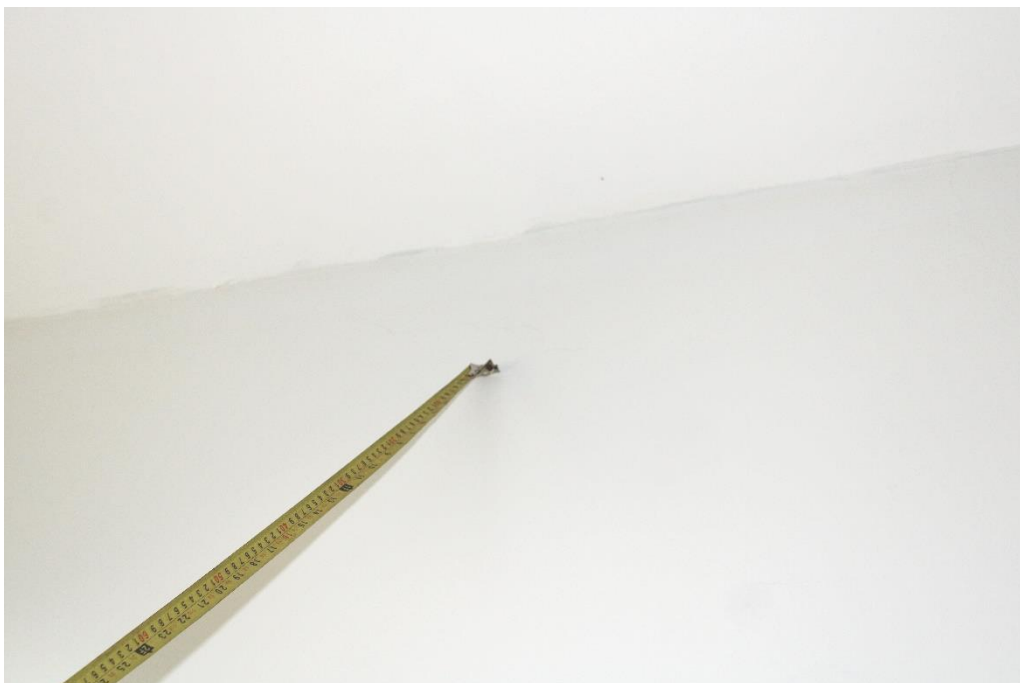
Foto nº 163. Em detalhe a Foto prévia, destacando fissura.
