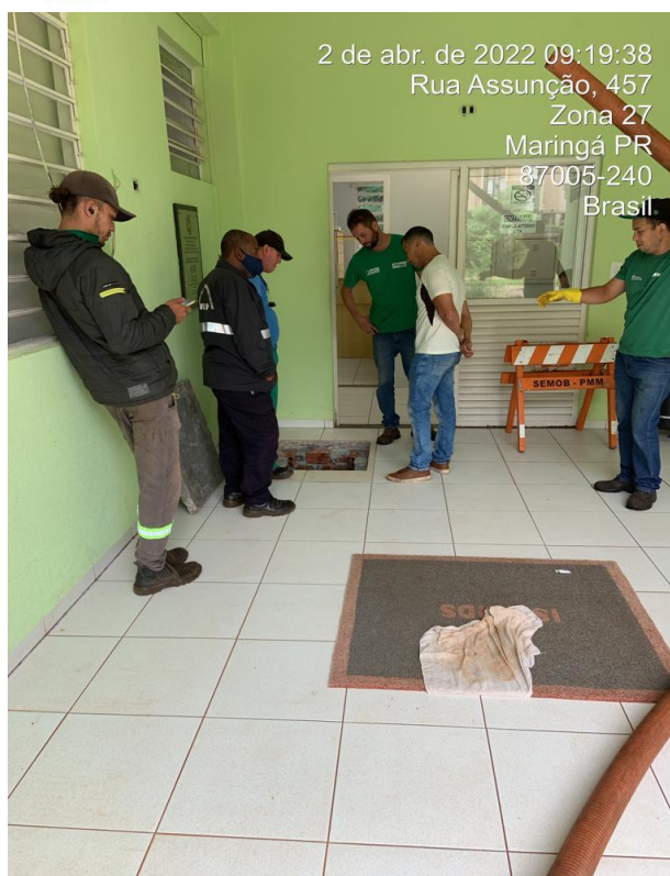
Foto nº 219. Vista da região da CE4, destacando funcionários analisando obstrução do sistema de esgoto.
