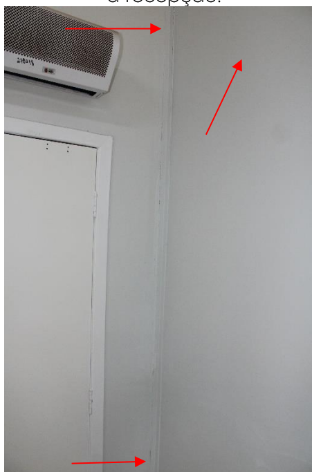
Foto nº 138. Vista parcial da recepção (região de interface entre blocos construtivos executados em épocas distintas, destacando perfil dando acabamento em possível junta, bem como fissura em alvenaria).
