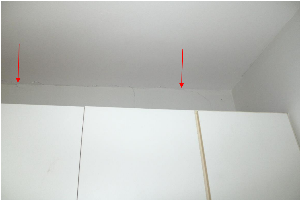
Foto nº 194. Vista parcial da sala 51, destacando fissura em laje de teto.
