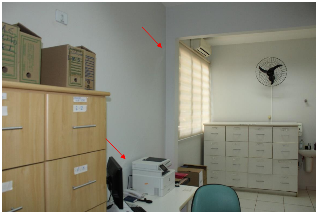
Foto nº 184. Vista parcial da sala 49, destacando sinais de reparos em fissura diagonal.
