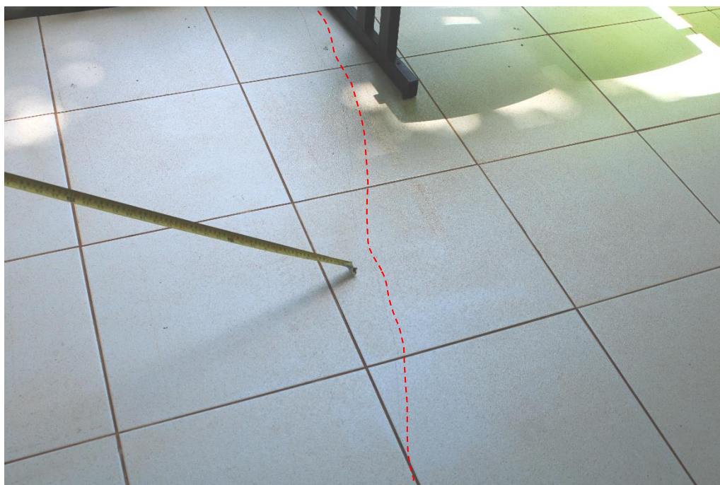
Foto nº 16. Em detalhe a Foto supra, destacando fissura no revestimento cerâmico (piso).
