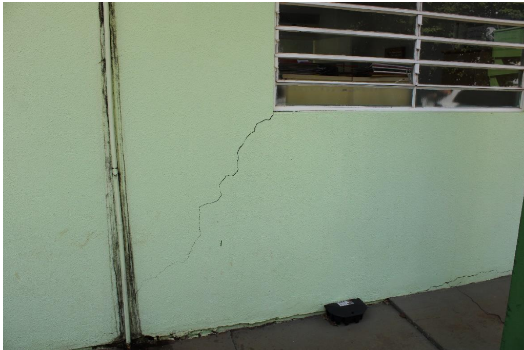
Foto nº 71. Em detalhe a foto acima, destacando trinca de conformação diagonal em vértice inferior da janela (região da recepção).
