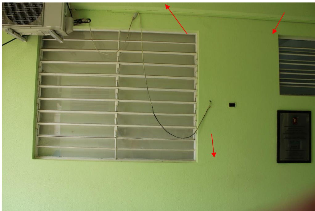
Foto nº 132. Vista parcial da varanda, destacando fissura em alvenaria.
