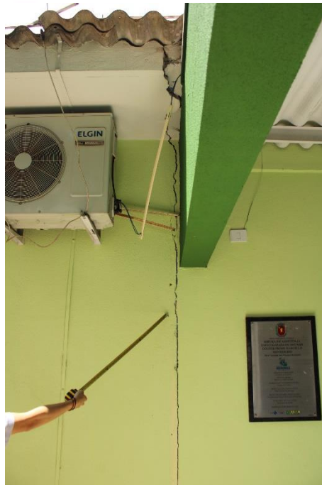
Foto nº 25. Trinca conformação vertical na região de interface entre os blocos construtivos supra qualificados.
