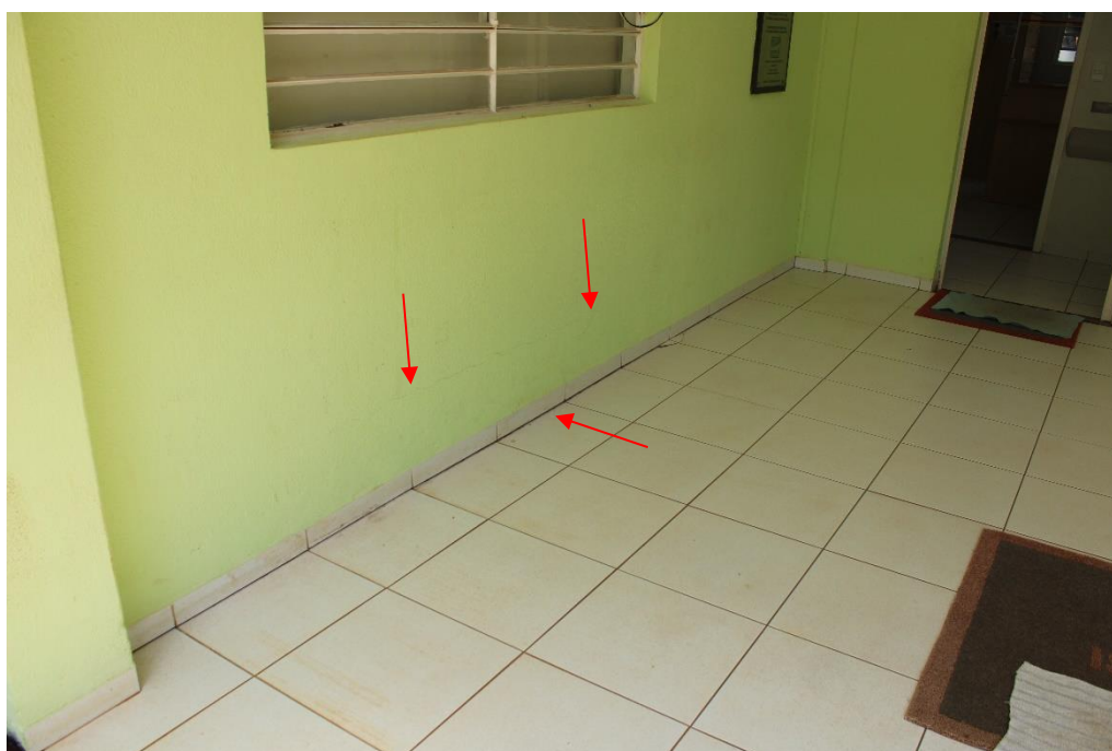
Foto nº 130. Vista parcial da varanda, destacando fissura horizontal em alvenaria, bem como acomodação do piso.
