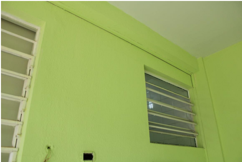
Foto nº 135. Em detalhe a Foto 133, destacando fissura horizontal no vértice superior de janela.
