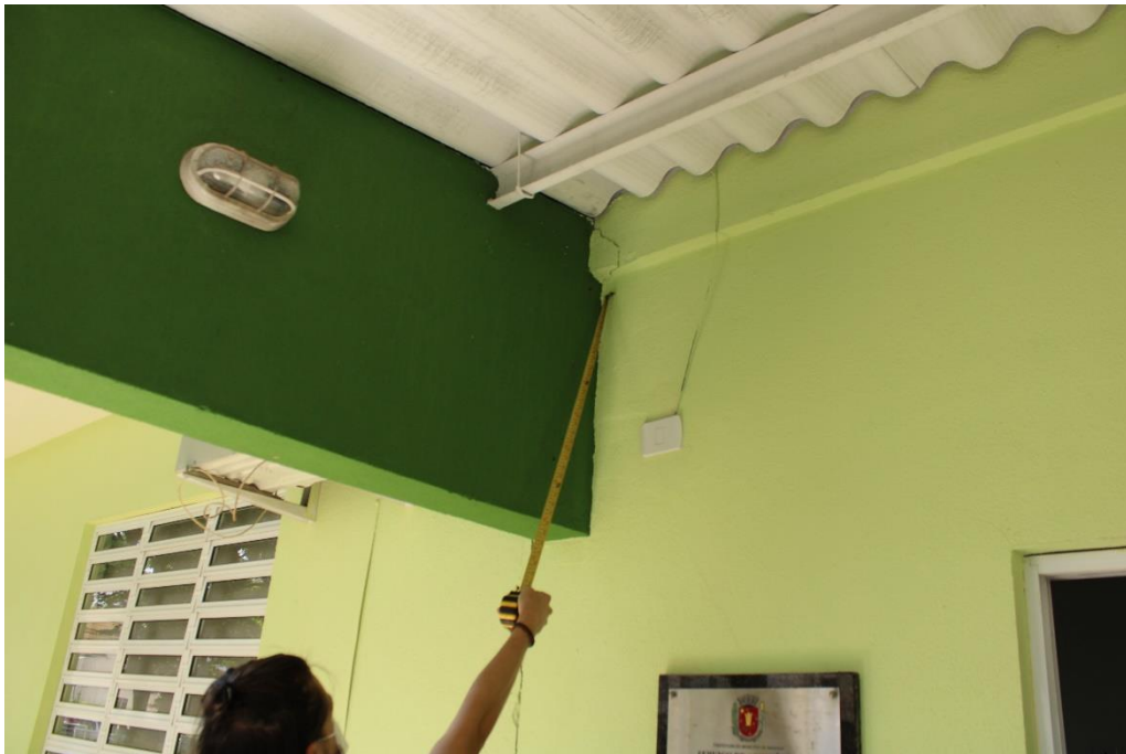
Foto nº 23. Descolamento do revestimento argamassado na região de interface entre os blocos construtivos.
