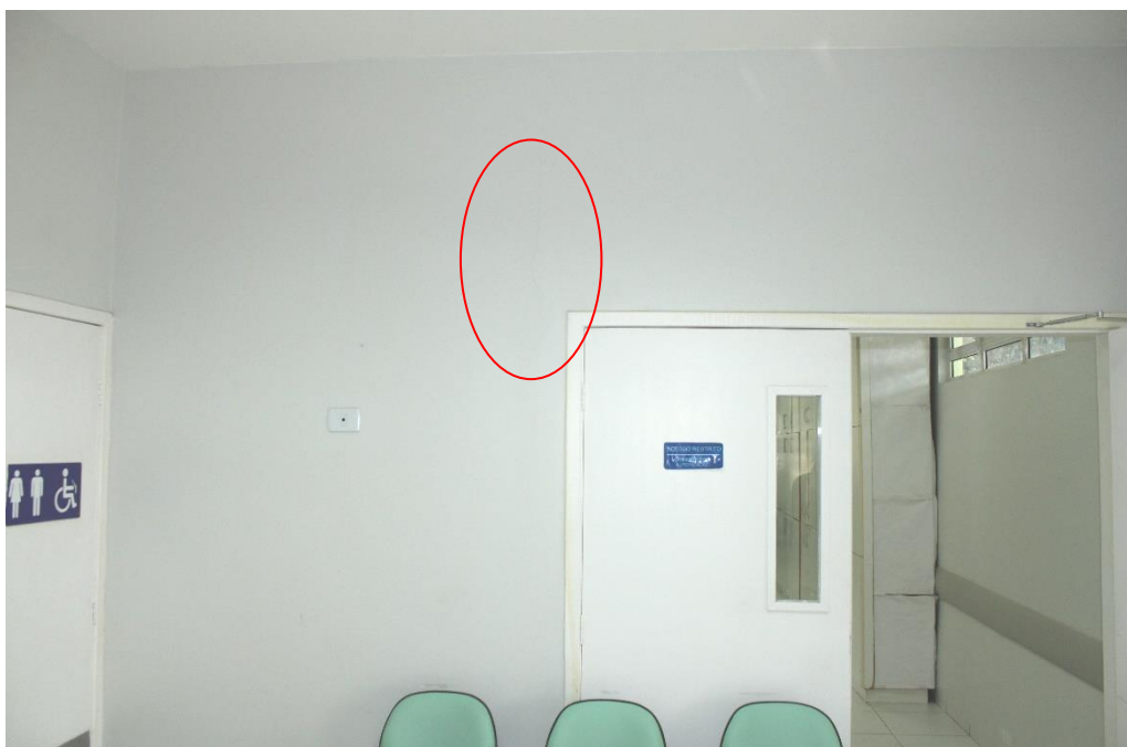
Foto nº 199. Vista parcial da recepção do CTA, destacando fissura vertical em alvenaria.
