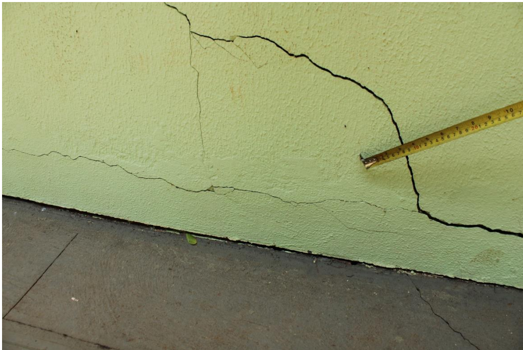
Foto nº 43. Em detalhe a Foto acima, destacando sinais de reparos em alvenaria. (diferença de relevo entre o revestimento argamassado e decorativo – película de pintura).
