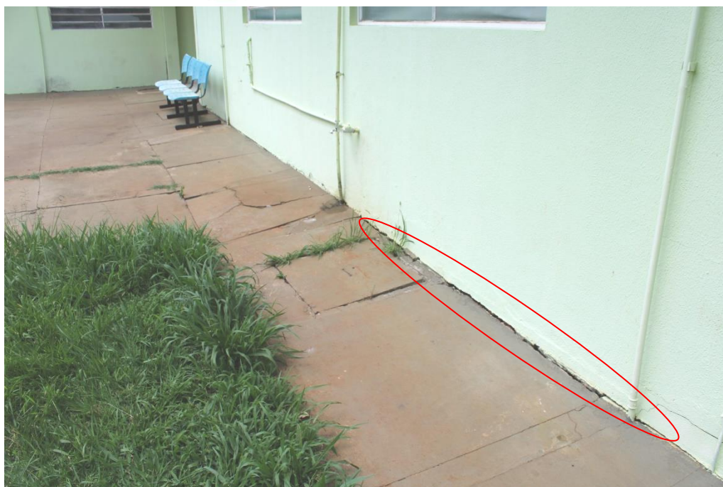
Foto nº 55. Vista parcial da Fachada Lateral Esquerda, destacando acomodação do calçamento externo em concreto desempenado, sinais de reparos na parte inferior da alvenaria, fissuras e irregularidades quanto à planicidade do calçamento.
