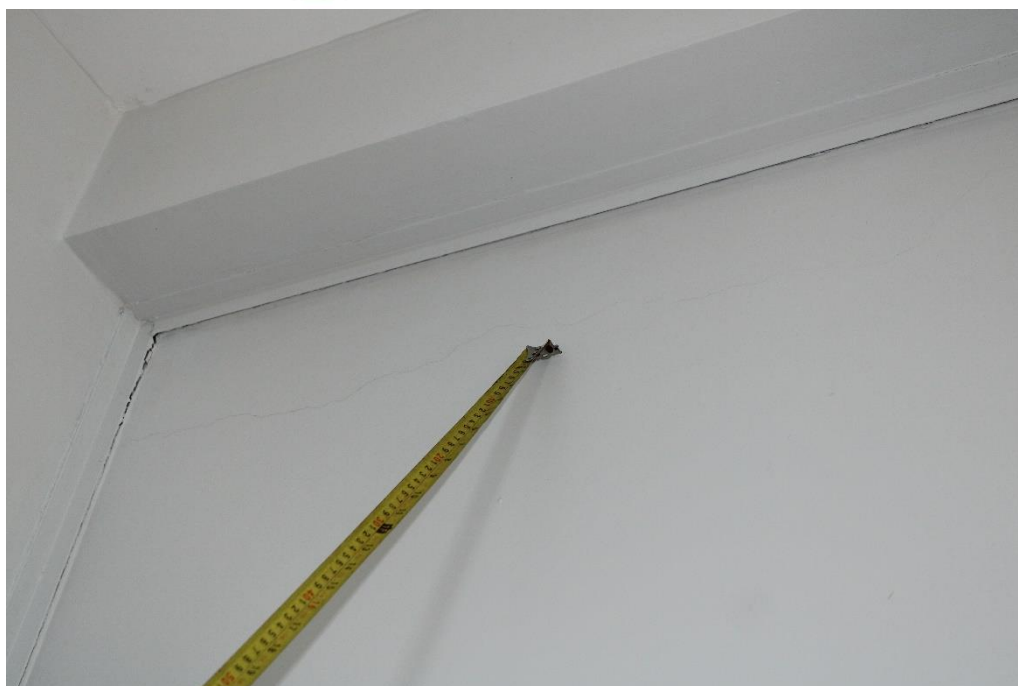
Foto nº 139. Em detalhe a foto supra, destacando fissura em alvenaria.
