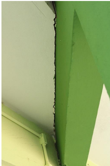
Foto nº 75. Em detalhe a Foto supra, destacando dessolidarização entre laje do beiral e elemento de concreto armado.
