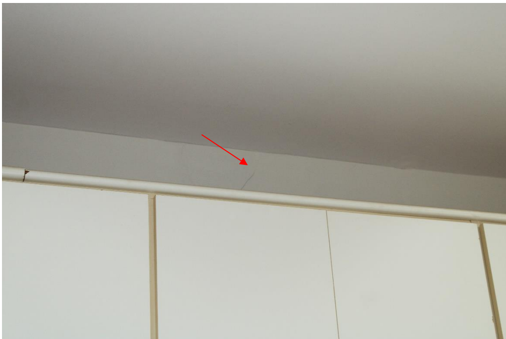
Foto nº 157. Em detalhe a Foto supra, destacando fissura em alvenaria.
