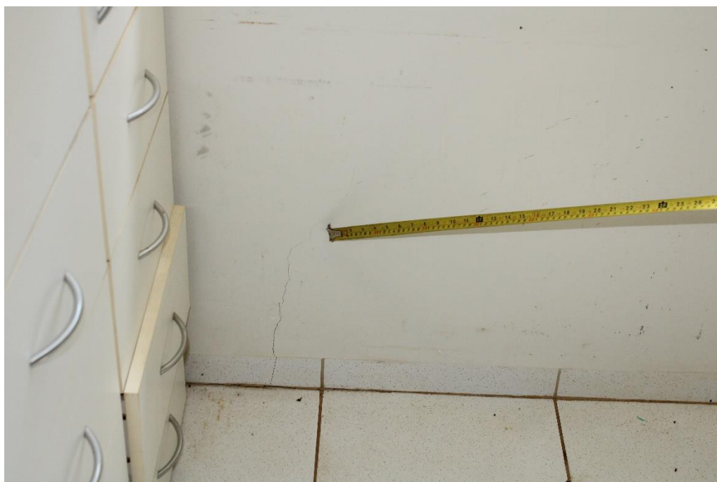
Foto nº 114. Em detalhe a Foto 111, destacando fissura de conformação vertical.
