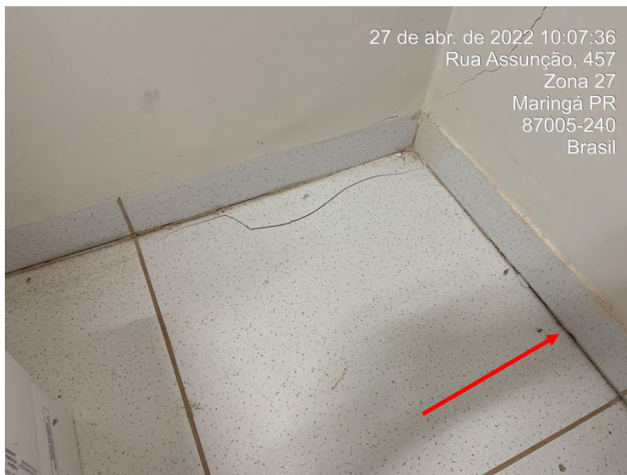
Foto nº 81. Em detalhe a Foto supra, destacando fissura em revestimento cerâmico (piso) e acomodação do piso.
