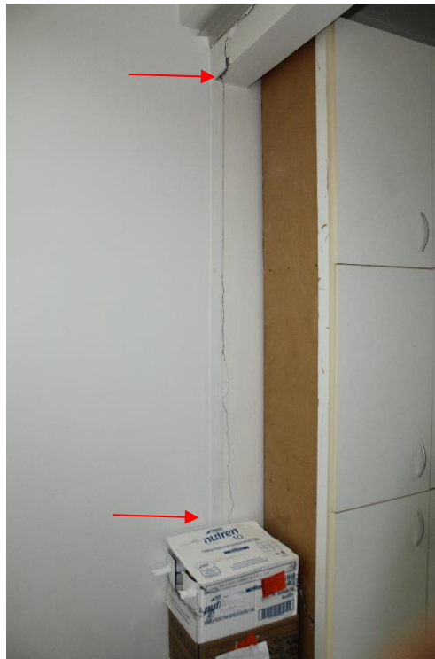
Foto nº 186. Vista parcial da sala 51, destacando fissura vertical em região de interface entre blocos construtivos distintos (região de ampliação).
