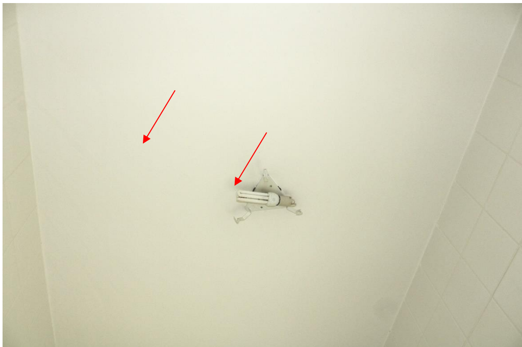
Foto nº 128. Vista da laje de teto do BWC feminino, destacando fissura em laje.
