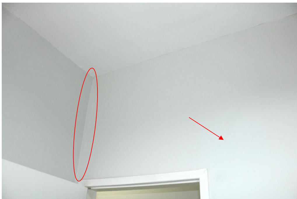
Foto nº 153. Vista parcial da sala 48, destacando fissura vertical na interface entre paredes e fissura diagonal em vértice superior da porta, ambas com sinais de reparos pretéritos.
