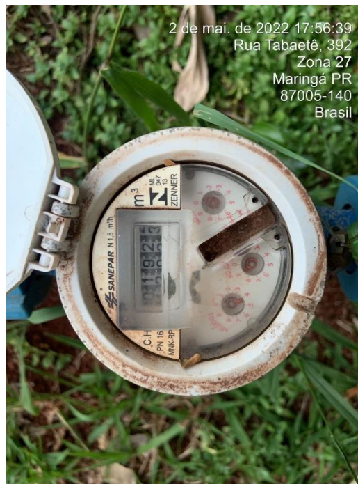
Foto nº229: Aferição do hidrômetro imediatamente após o fechamento do registro de abastecimento da caixa d'água.
