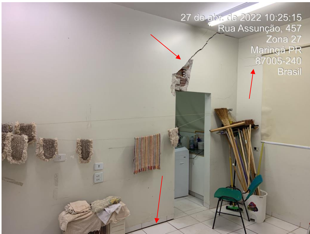
Foto nº 115. Vista parcial da sala 50, destacando acomodação do piso, rachadura diagonal em alvenaria sobre abertura (porta) e, ainda, fissuras horizontais em vértice superior da janela.
