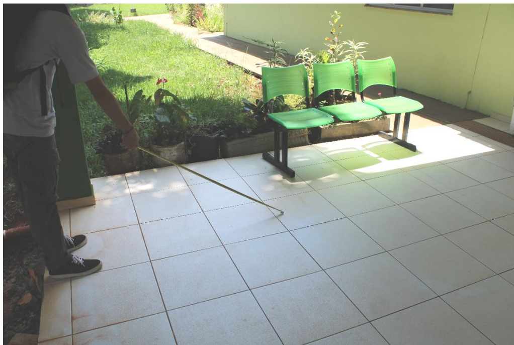
Foto nº 15. Fissura em revestimento cerâmico (piso) na região qualificada na Foto supra.
