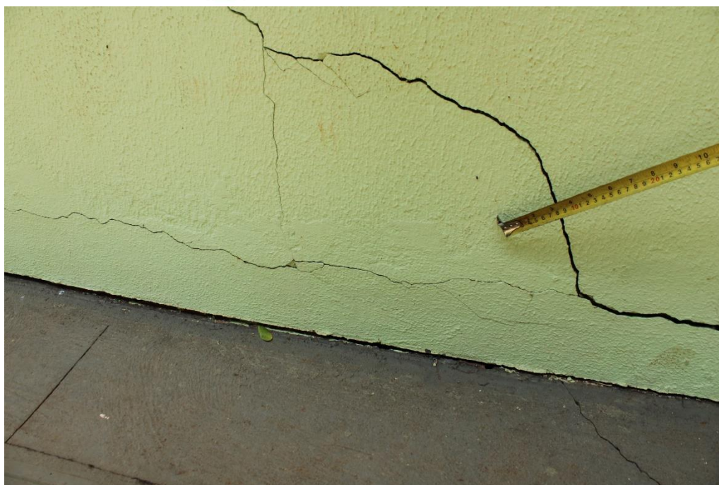
Foto nº 43. Em detalhe a Foto acima, destacando sinais de reparos em alvenaria. (diferença de relevo entre o revestimento argamassado e decorativo – película de pintura).
