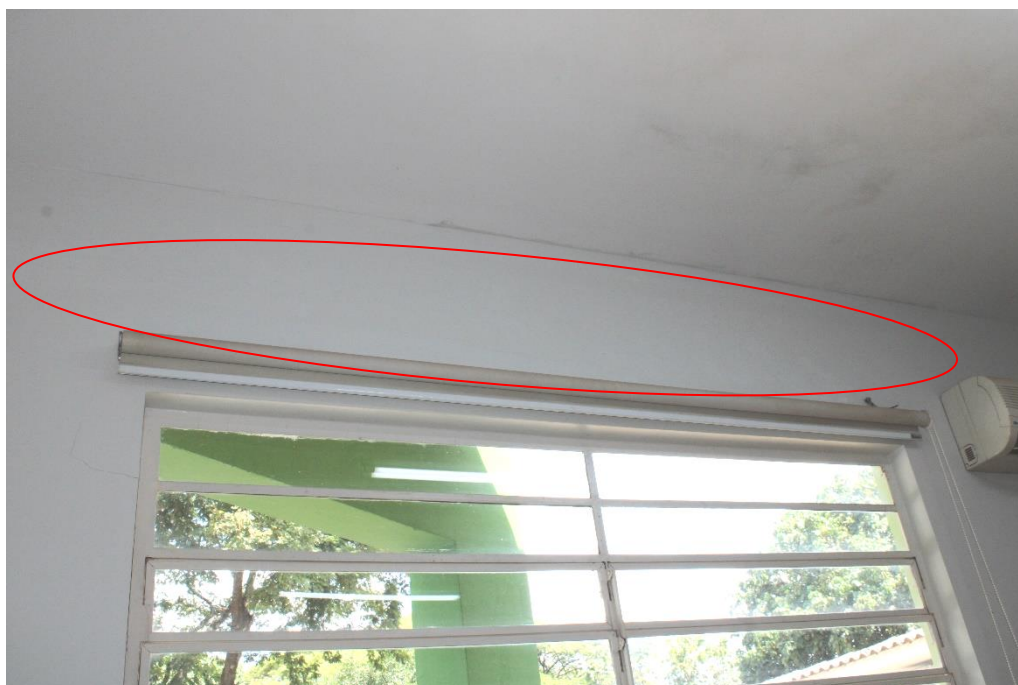
Foto nº 145. Vista parcial da sala 47, destacando fissura horizontal com sinais de reparos primitivos.
