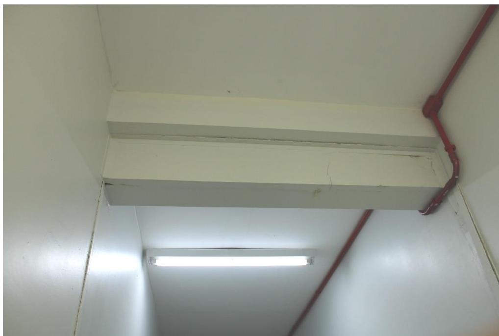
Foto nº 98. Em detalhe a Foto 96, destacando fissuras em viga de concreto armado.
