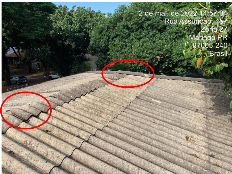
Foto nº 209. Vista parcial da cobertura sobre região ampliada em 2015, destacando cumeeiras e espigão quebradas e levantadas.
