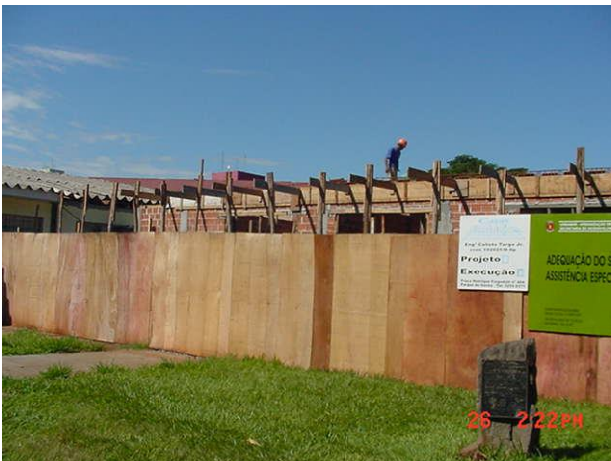
Figura 7. Registro Técnico Fotográfico encaminhado pelo Eng. Civil Rafael, já qualificado, da obra de ampliação da Policlínica, destacando objeto em apreço.
