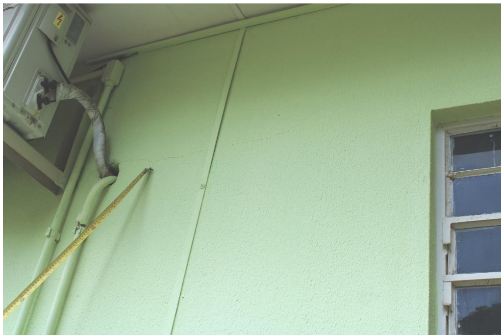
Foto nº 54. Em detalhe a Foto 52, destacando fissura de conformação horizontal.
