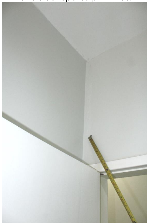
Foto nº 155. Em detalhe a Foto 153, destacando fissura vertical com sinais de reparos pretéritos.
