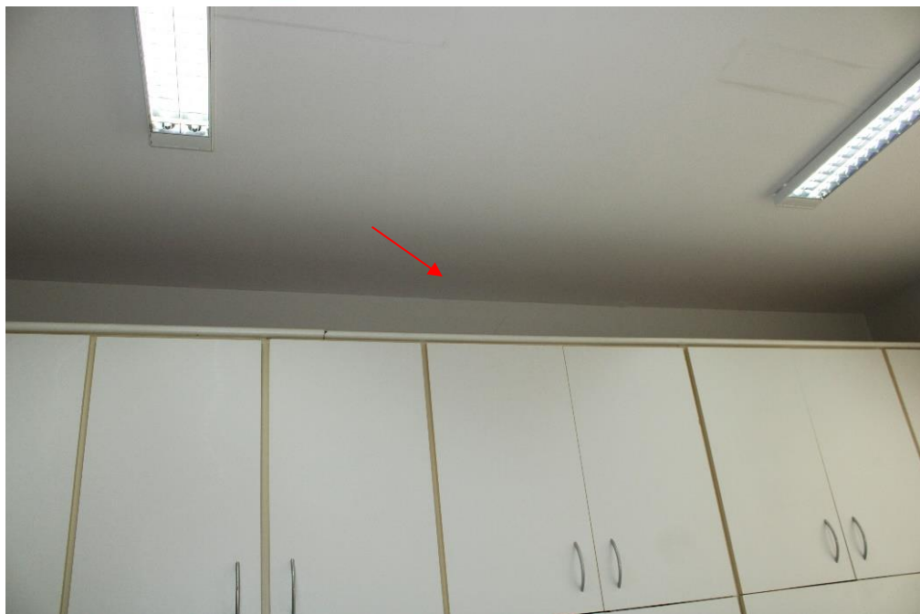
Foto nº 156. Vista parcial da sala 48, destacando fissura vertical em alvenaria.
