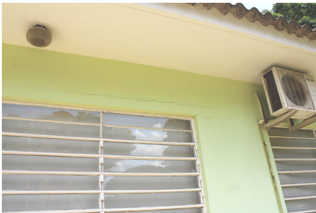
Foto nº 59. Em detalhe a Foto 57, destacando trinca de conformação horizontal (do tipo "escamada") sobre janela, bem como trinca horizontal/diagonal no vértice superior dessa.
