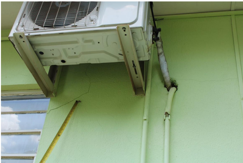
Foto nº 58. Em detalhe a Foto acima, destacando fissura/trinca de conformação diagonal em vértice superior da janela da sala 52, visualizada externamente.
