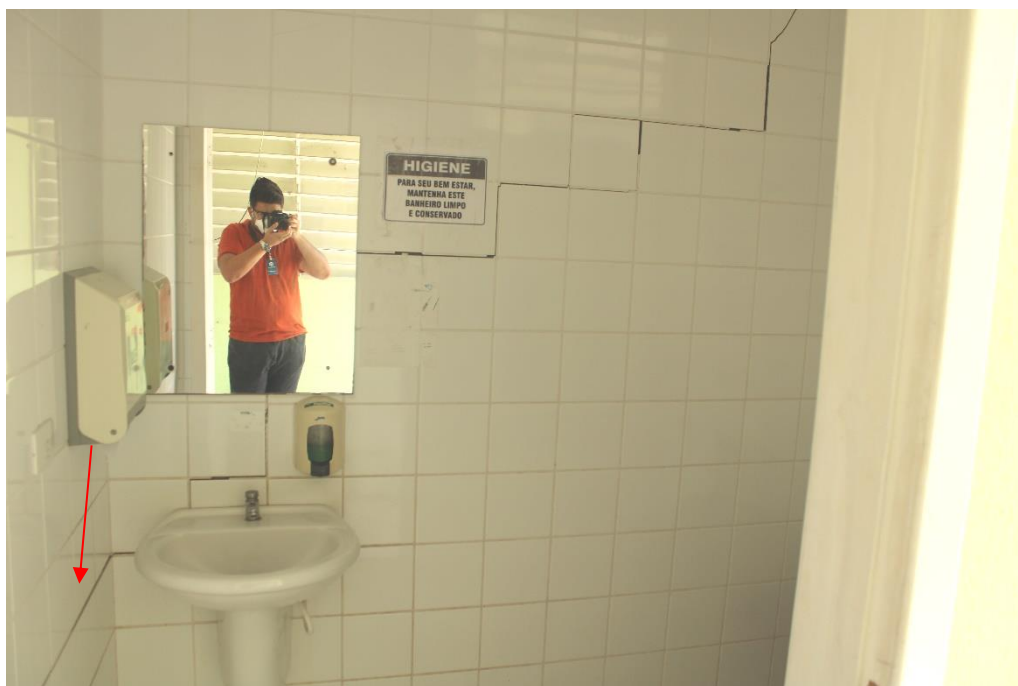
Foto nº 122. Vista parcial do BWC masculino, já qualificado, destacando trincas diagonal e horizontal em alvenaria, com efeito no revestimento cerâmico da parede e, ainda, som cavo à percussão nesse.
