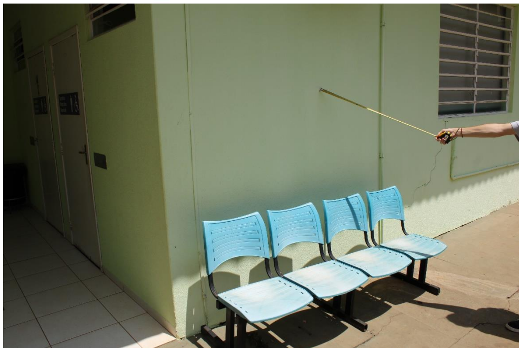
Foto nº 63. Vista parcial da Fachada Lateral Esquerda (região do bwc masculino), destacando fissura de conformação horizontal.
