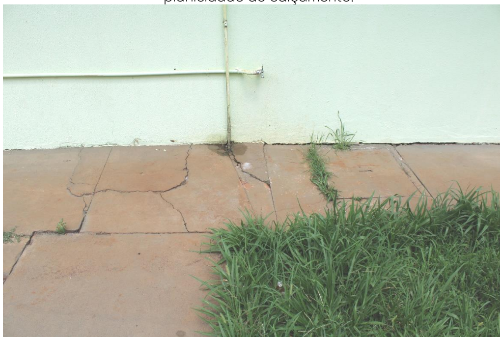
Foto nº 56. Vista da região supra qualificada, destacando sinais de reparos em alvenaria (parte inferior) e umedecimento do calçamento externo na região do dreno de ar condicionado.
