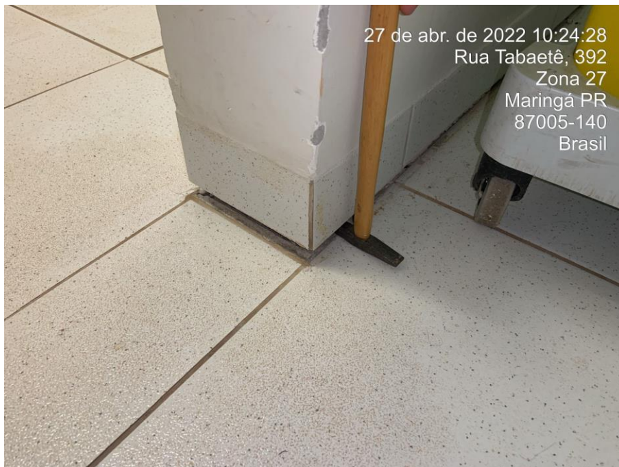
Foto nº 105. Em detalha a Foto supra, destacando acomodação do piso.
