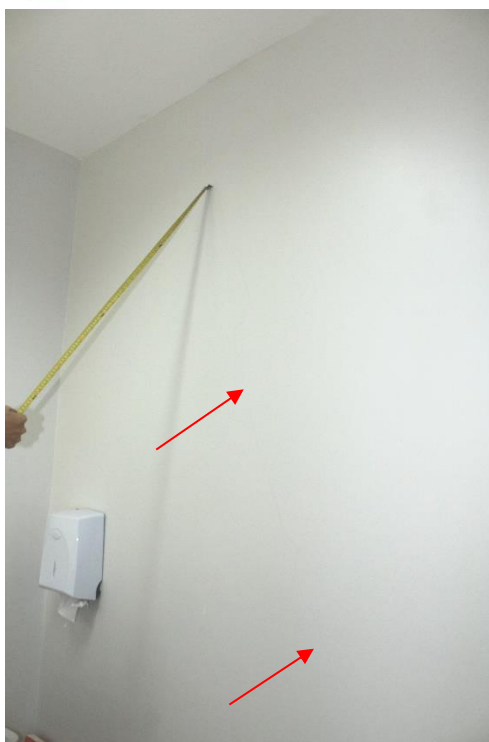
Foto nº 190. Em detalhe a Foto 188, destacando fissura diagonal.
