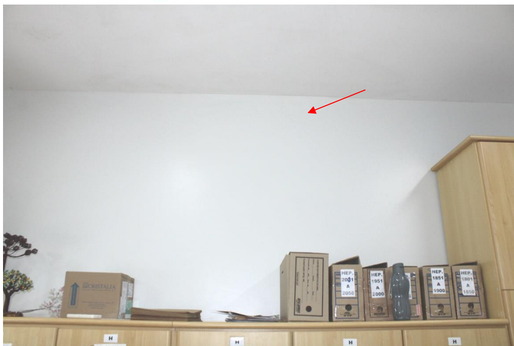
Foto nº 148. Vista parcial da sala 47, destacando fissura vertical.
