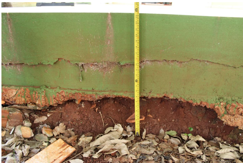
Foto nº 13. Em detalhe a Foto supra, destacando 25 centímetros de desconfinamento do solo base do aterro/talude.
