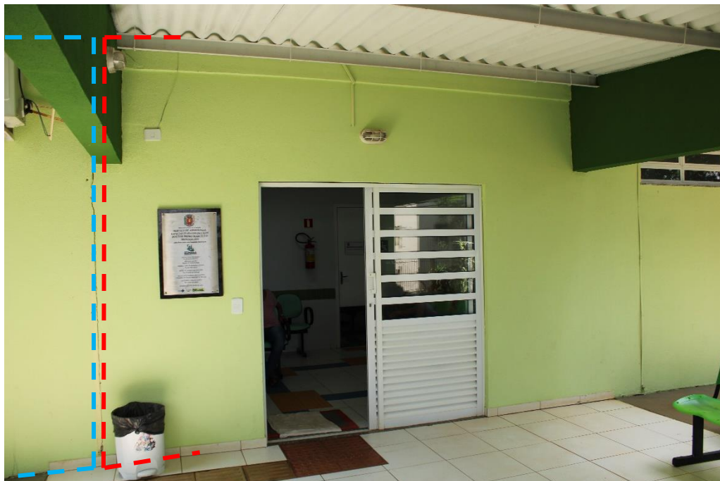
Foto nº 22. Vista parcial da fachada frontal (região de acesso à recepção do CTA), em destaque região de interface entre blocos construtivos executados em épocas distintas. À esquerda (em azul) bloco executado em 2007, à direita (em vermelho) bloco executado em 2015.
