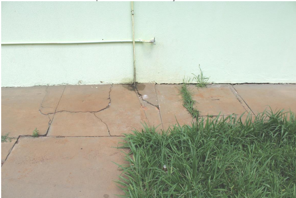
Foto nº 56. Vista da região supra qualificada, destacando sinais de reparos em alvenaria (parte inferior) e umedecimento do calçamento externo na região do dreno de ar condicionado.
