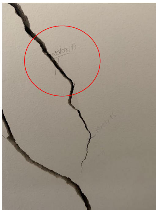
Figura 12. Registro técnico fotográfico destacando marcação em fissura realizada em 23/07/2015, s.m.j.
