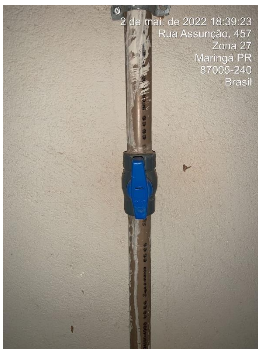
Foto nº232: Registro do ramal de abastecimento do reservatório de água superior fechado.
