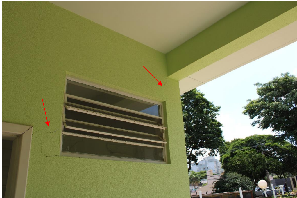
Foto nº 121. Em detalhe a Foto supra, destacando trincas nos vértices da janela.
