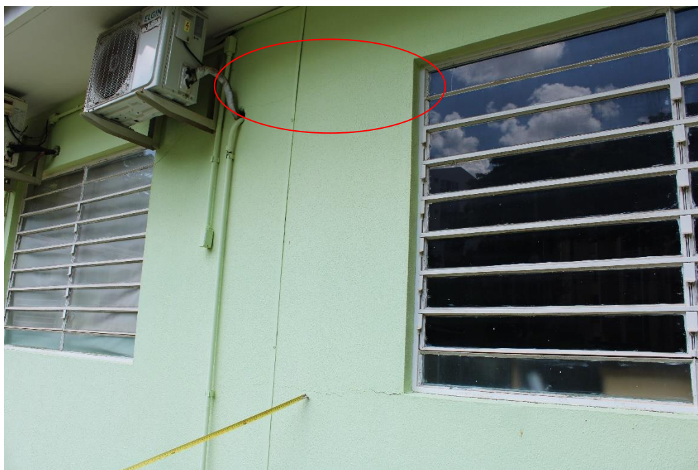
Foto nº 52. Vista parcial da Fachada Lateral Esquerda (região da coordenação – sala 53), destacando fissura de conformação horizontal em vértice inferior da janela.
