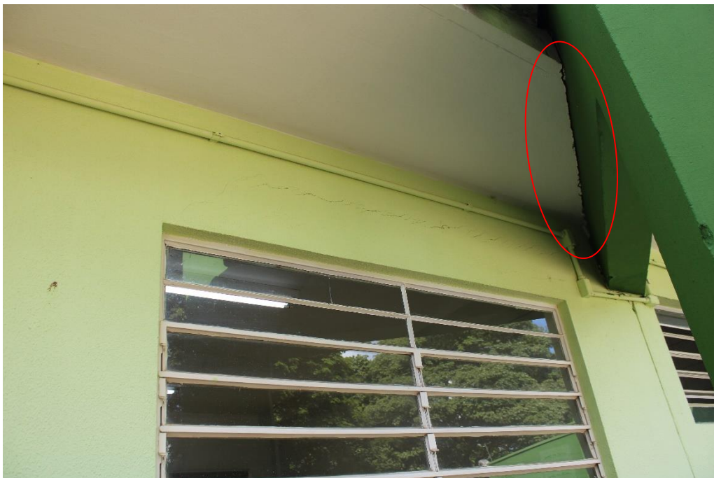
Foto nº 74. Em detalhe a Foto 70, destacando trinca horizontal sobre janela (região da recepção).
