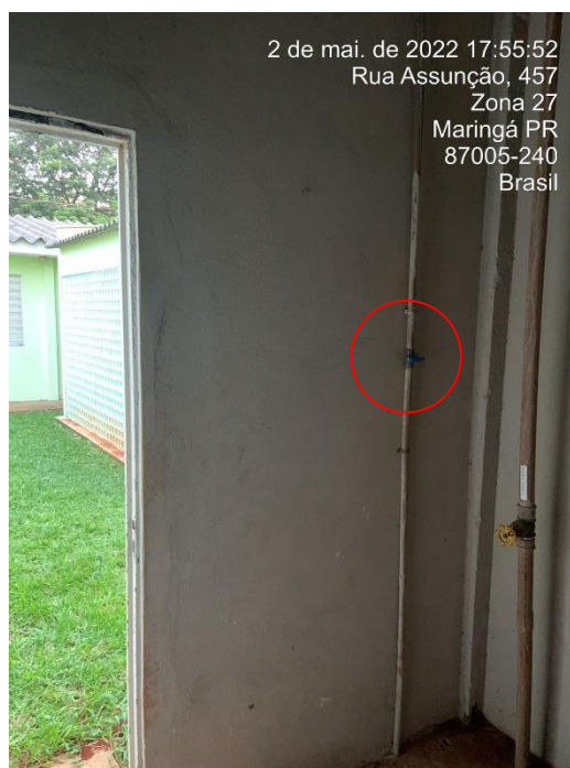
Foto nº228: Vista da região infra à caixa d'água (reservatório superior), destacando registro de ramal de abastecimento fechado.
