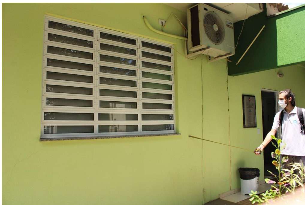
Foto nº 27. Vista parcial da fachada frontal, destacando fissura de conformação horizontal em vértice inferior da abertura.
