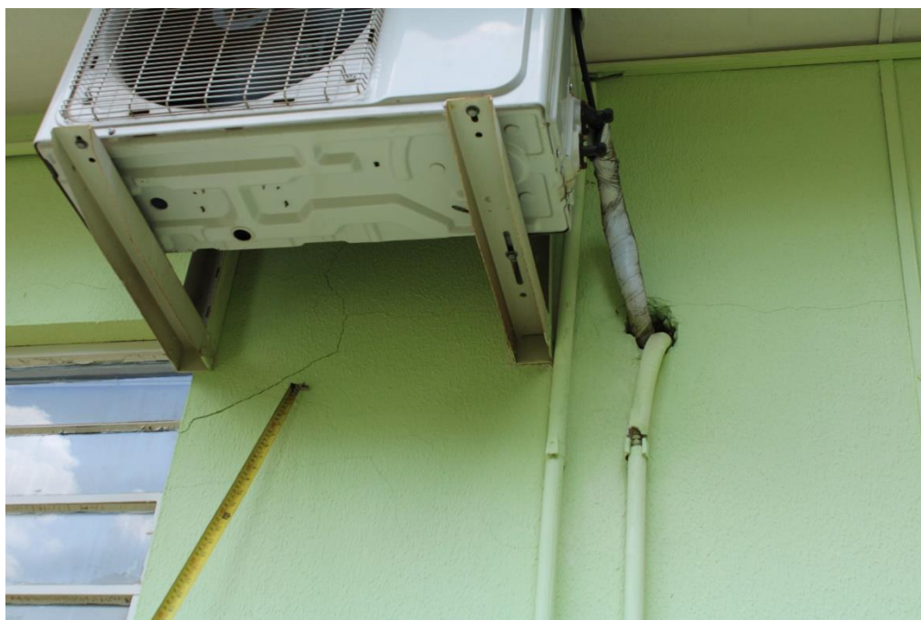
Foto nº 58. Em detalhe a Foto acima, destacando fissura/trinca de conformação diagonal em vértice superior da janela da sala 52, visualizada externamente.
