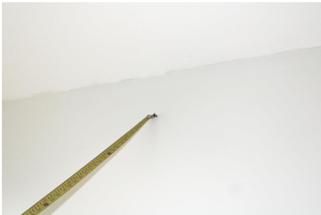
Foto nº 163. Em detalhe a Foto prévia, destacando fissura.
