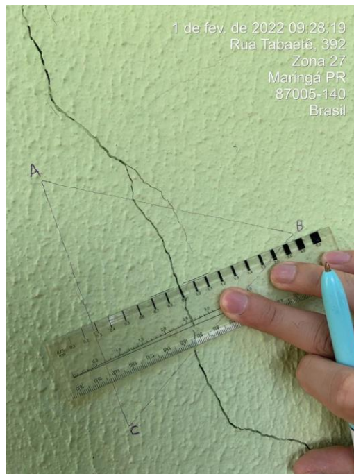
Foto nº 2. Vista da medição da abertura com auxílio de fissurômetro.
