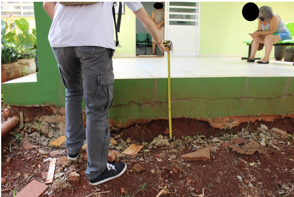
Foto nº 12. Técnico aquilatando magnitude do desconfinamento do solo base do aterro/talude, mediante medição in loco com auxílio de trena graduada.
