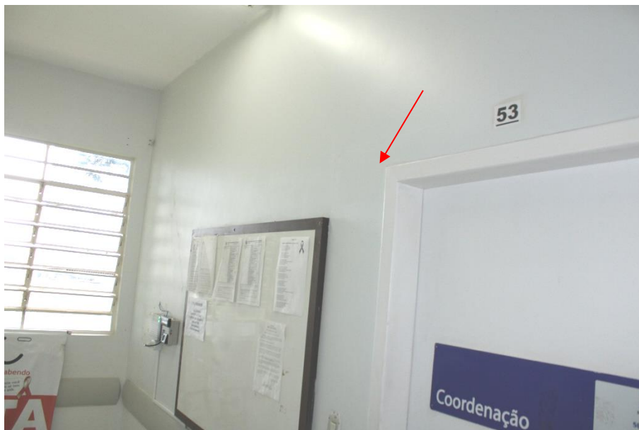
Foto nº 89. Vista parcial do corredor, destacando fissura no vértice superior da porta de acesso a sala 53.
