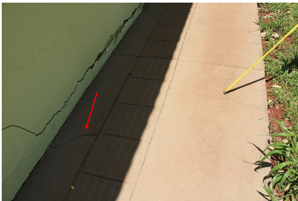
Foto nº 45. Vista parcial da Fachada Frontal, destacando fissuras no calçamento externo em concreto desempenado.
