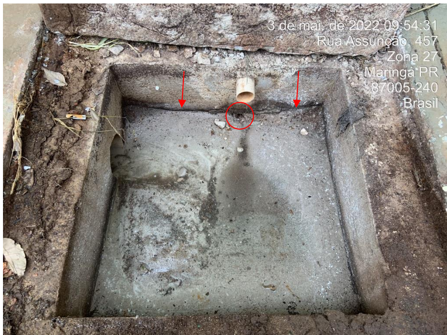
Foto nº 220. Vista da CE1, destacando fissura e abertura que comprometem a estanqueidade do elemento.
