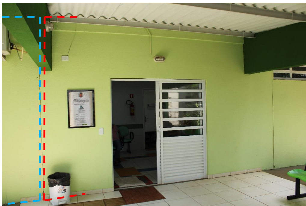
Foto nº 22. Vista parcial da fachada frontal (região de acesso à recepção do CTA), em destaque região de interface entre blocos construtivos executados em épocas distintas. À esquerda (em azul) bloco executado em 2007, à direita (em vermelho) bloco executado em 2015.
