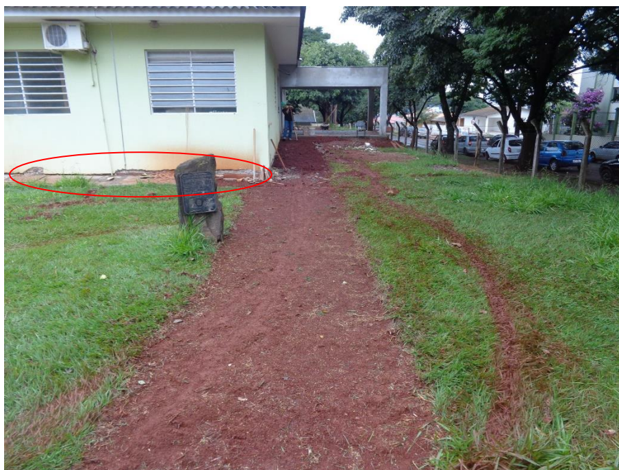
Figura 10. Registro Técnico Fotográfico encaminhado pelo Eng. Civil Rafael, já qualificado, da obra de ampliação da Policlínica (2014/2015).
