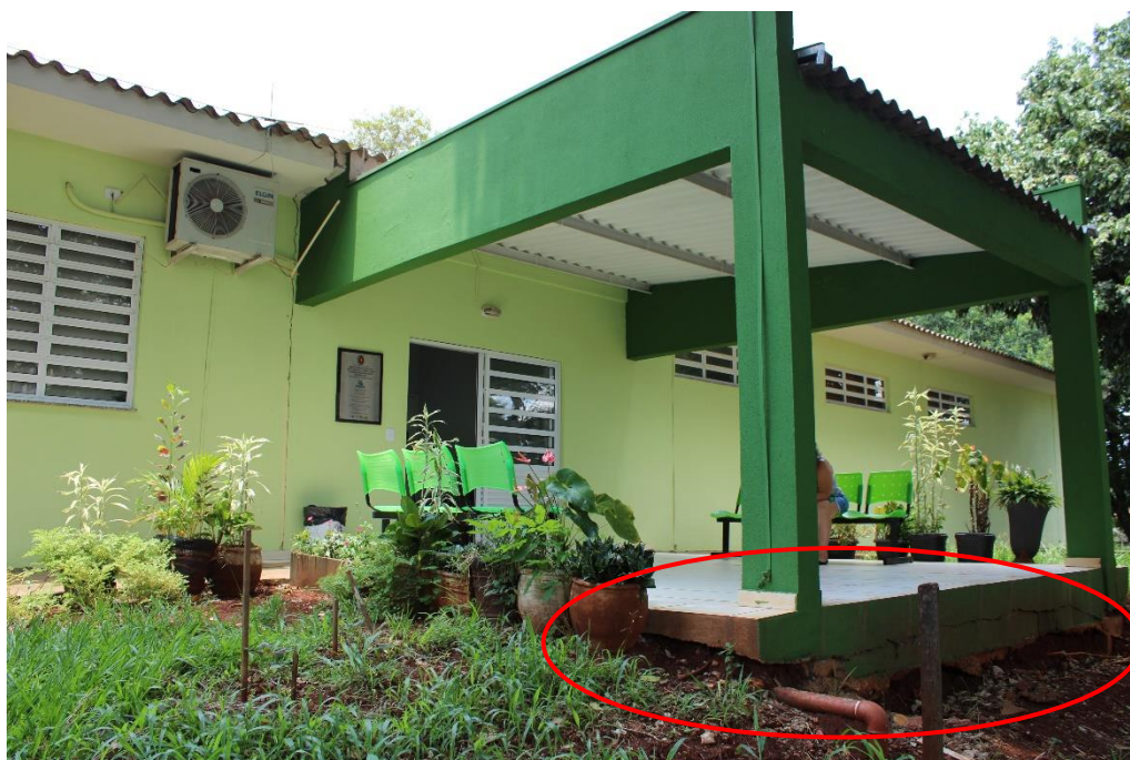
Foto nº 10. Vista parcial da Fachada Frontal, destacando desconfinamento de solo do aterro/talude.
