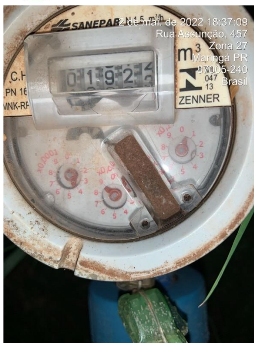
Foto nº231: Aferição do hidrômetro após 26 minutos da segunda medição.
