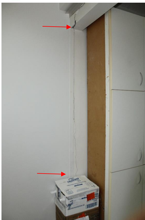
Foto nº 186. Vista parcial da sala 51, destacando fissura vertical em região de interface entre blocos construtivos distintos (região de ampliação).
