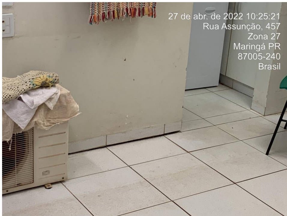
Foto nº 116. Em detalhe a Foto acima, destacando acomodação do piso.
