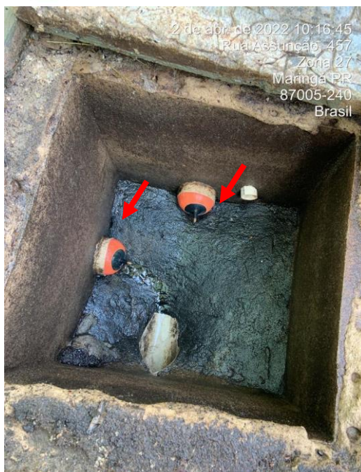
Foto nº 222. Vista da CE2, destacando aberturas ("buracos") na região do fundo.
