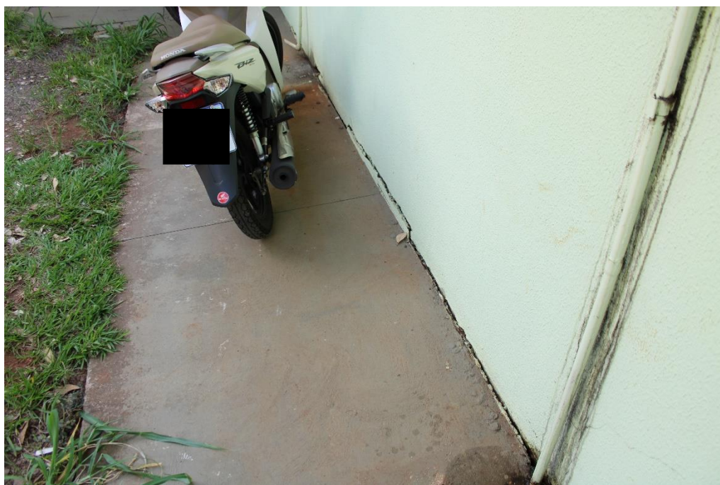
Foto nº 76. Em detalhe a Foto 70, destacando acomodação do calçamento externo e trinca horizontal na região inferior da parede de alvenaria.
