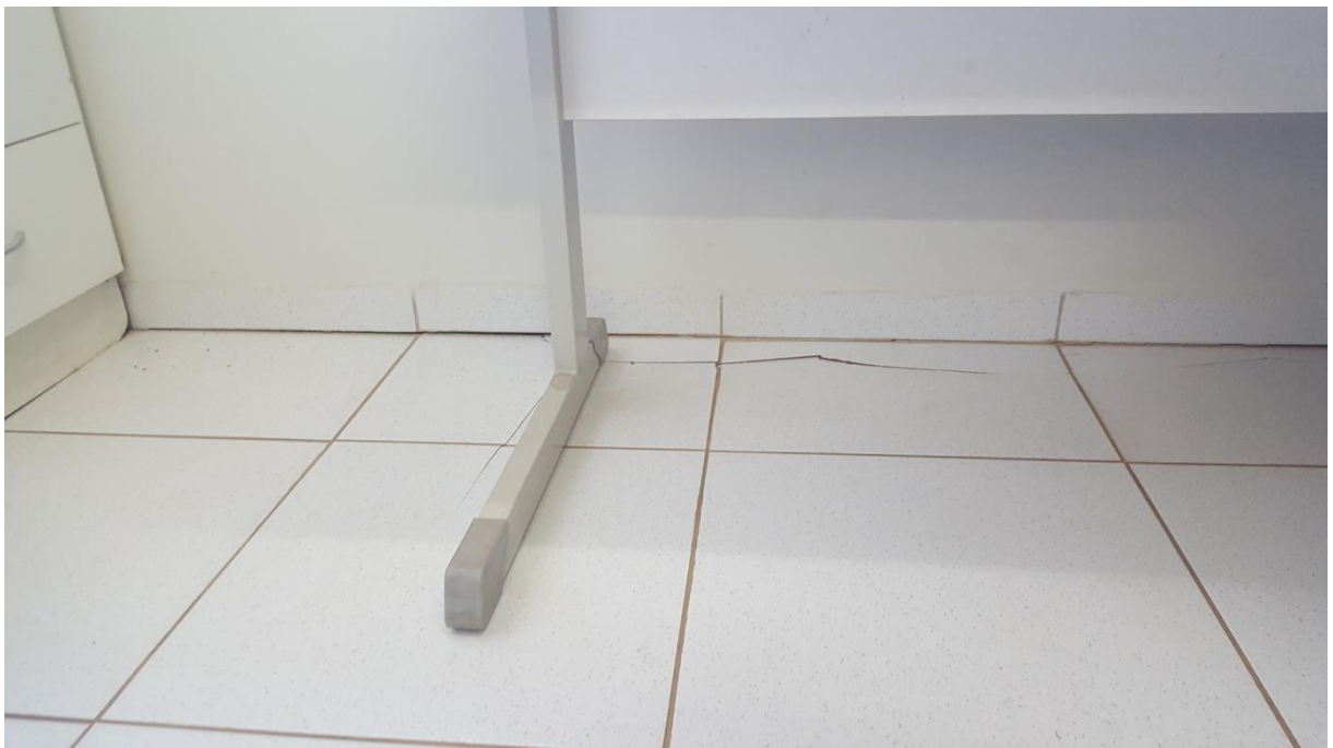
Figura 15. Vista de trinca em piso cerâmico, não sendo possível aquilatar a região de incidência. Foto datada em 07/04/2016.
