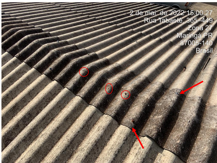
Foto nº 212. Vista parcial da cobertura sobre ampliação executada em 2015, destacando perfurações em cumeeira, ausência de fixação (parafuso) e trincas.
