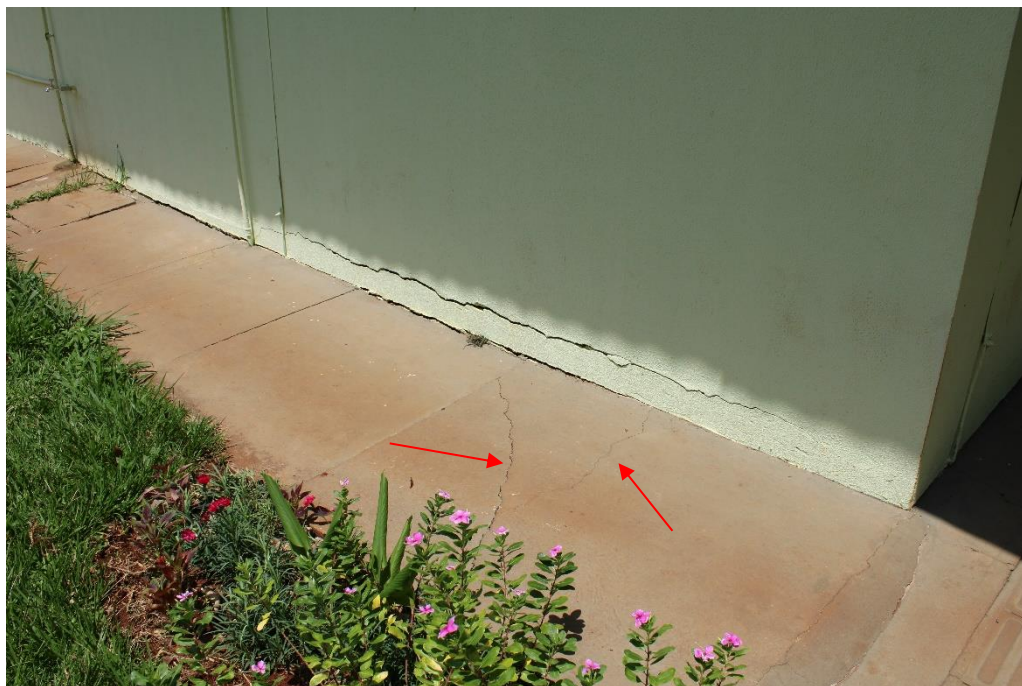
Foto nº 48. Em detalhe a Foto supra, destacando trinca horizontal em alvenaria, acomodação do calçamento externo e, ainda, fissuras no calçamento externo em concreto desempenado.
