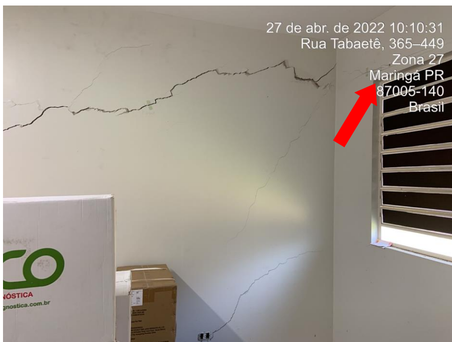
Foto nº 82. Vista parcial da sala 53, destacando trincas de conformações diagonal e horizontal em alvenaria.
