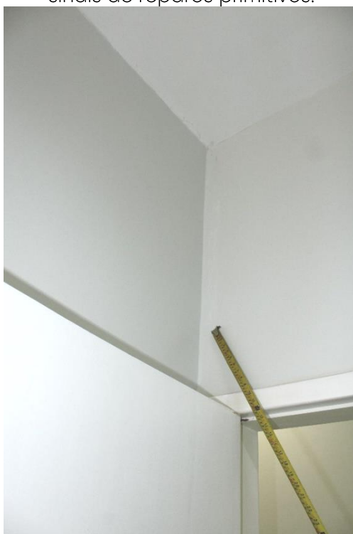
Foto nº 155. Em detalhe a Foto 153, destacando fissura vertical com sinais de reparos pretéritos.
