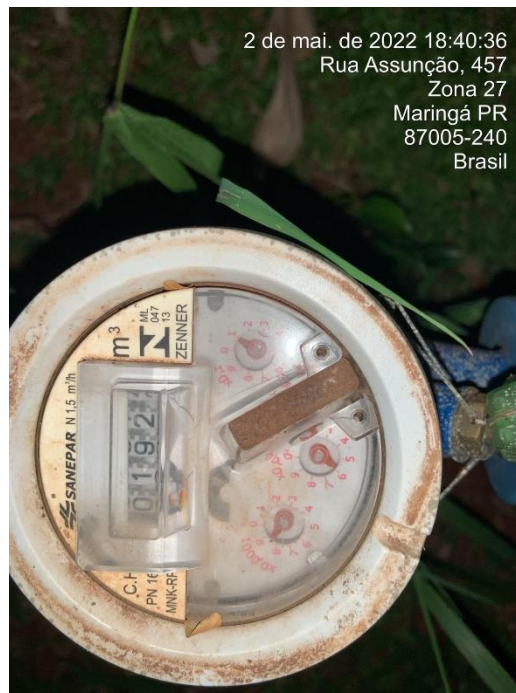
Foto nº233: Aferição do hidrômetro, apontando alteração de medida após a abertura do registro.
