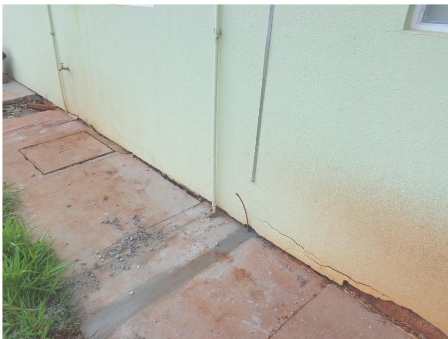
Figura 11. Em detalhe a Figura, em relevo destacamento de revestimento argamassado, fissuras e dessolidarização entre calçamento externo e parede de alvenaria.
