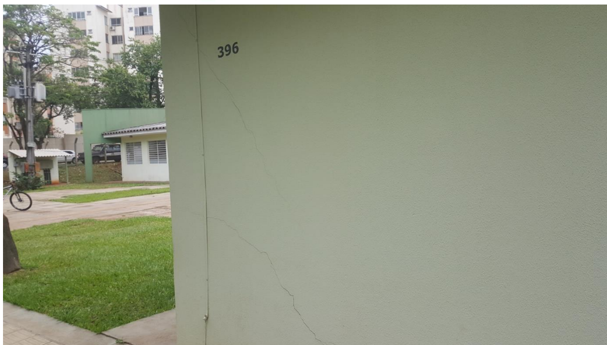
Figura 16. Vista de fissuras em parede localizada em parede externa (região da sala 53 – coordenação). Foto datada em 29/11/2016.
