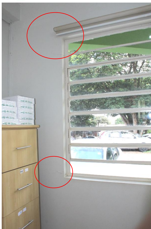
Foto nº 142. Vista parcial da sala 47, destacando fissura em vértices da janela.
