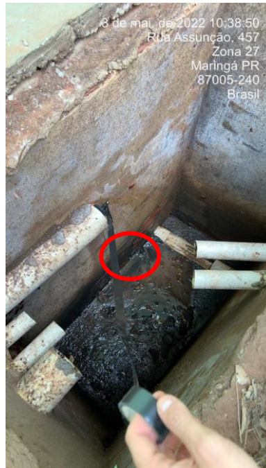
Foto nº 225. Vista da CE6, destacando afloramento de líquido em parede da caixa de esgoto.
