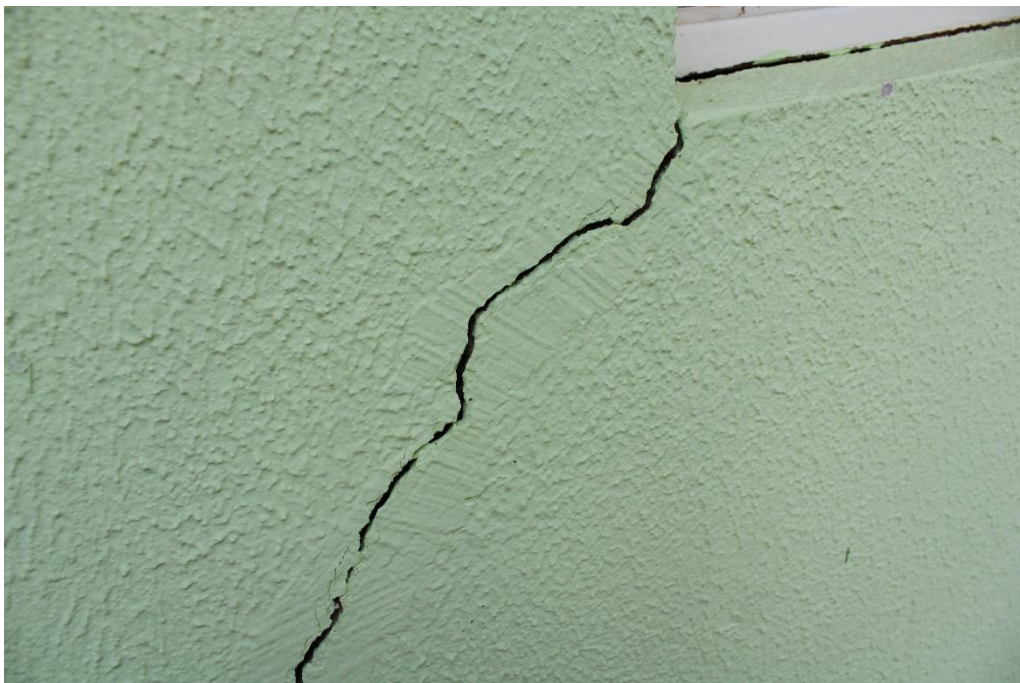
Foto nº 72. Em detalhe a Foto acima, destacando sinais de reparos primitivos na trinca visualizada.
