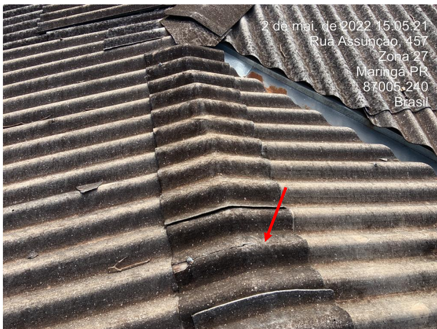
Foto nº 218. Em detalhe a Foto supra, destacando cumeeira quebrada e trincada.
