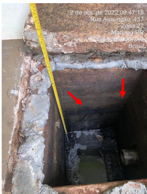
Foto nº 224. Vista da CE3, destacando fissura.
