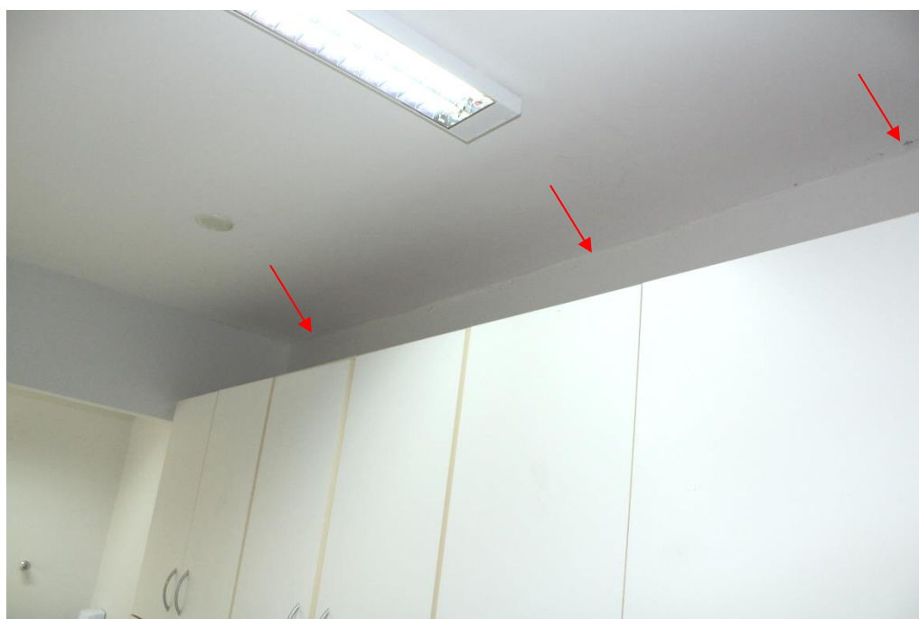
Foto nº 193. Vista parcial da sala 51, destacando fissura em laje de teto.
