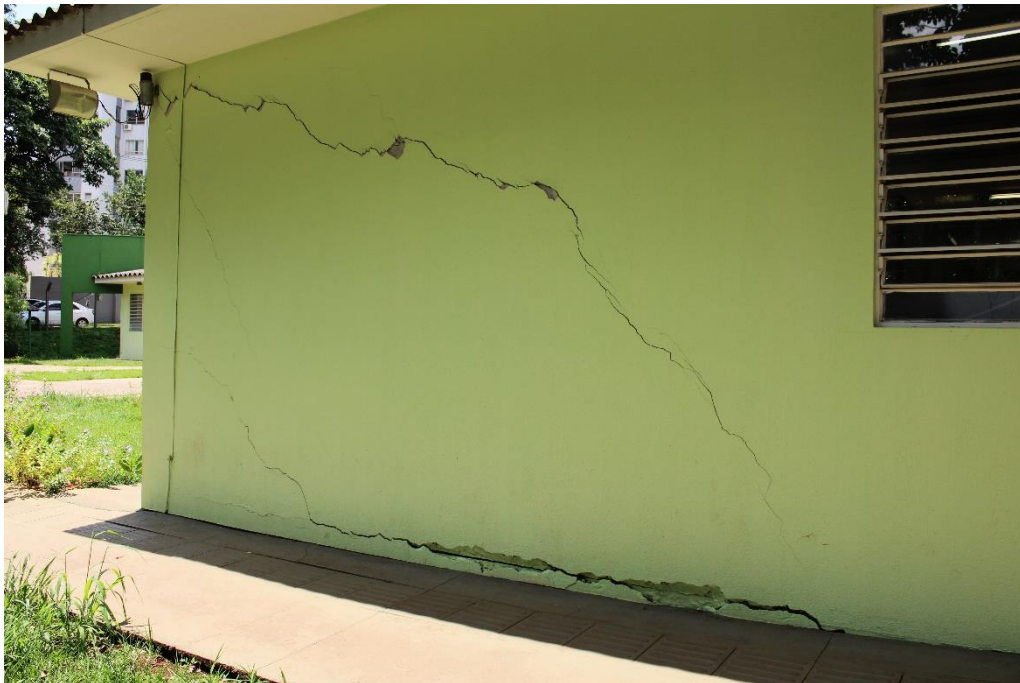
Foto nº 41. Vista parcial da Fachada Frontal (região da coordenação – sala 53), destacando lesões (fissuras e trincas) em alvenarias.
