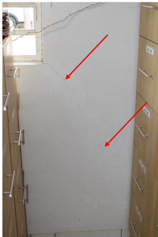
Foto nº 147. Trinca diagonal, com sinais de reparos pretéritos, em vértice inferior da janela.
