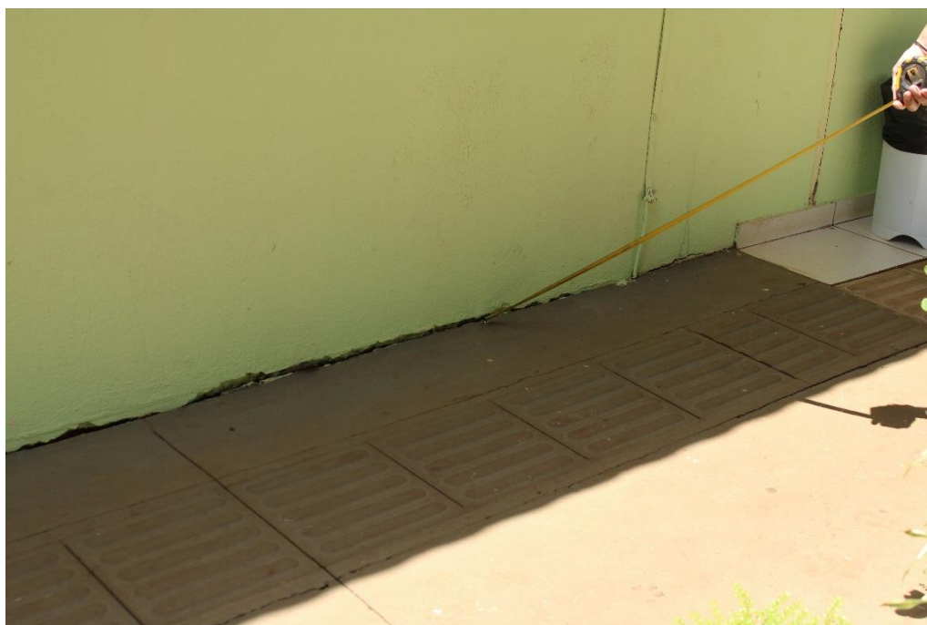
Foto nº 30. Em detalhe a Foto prévia.
