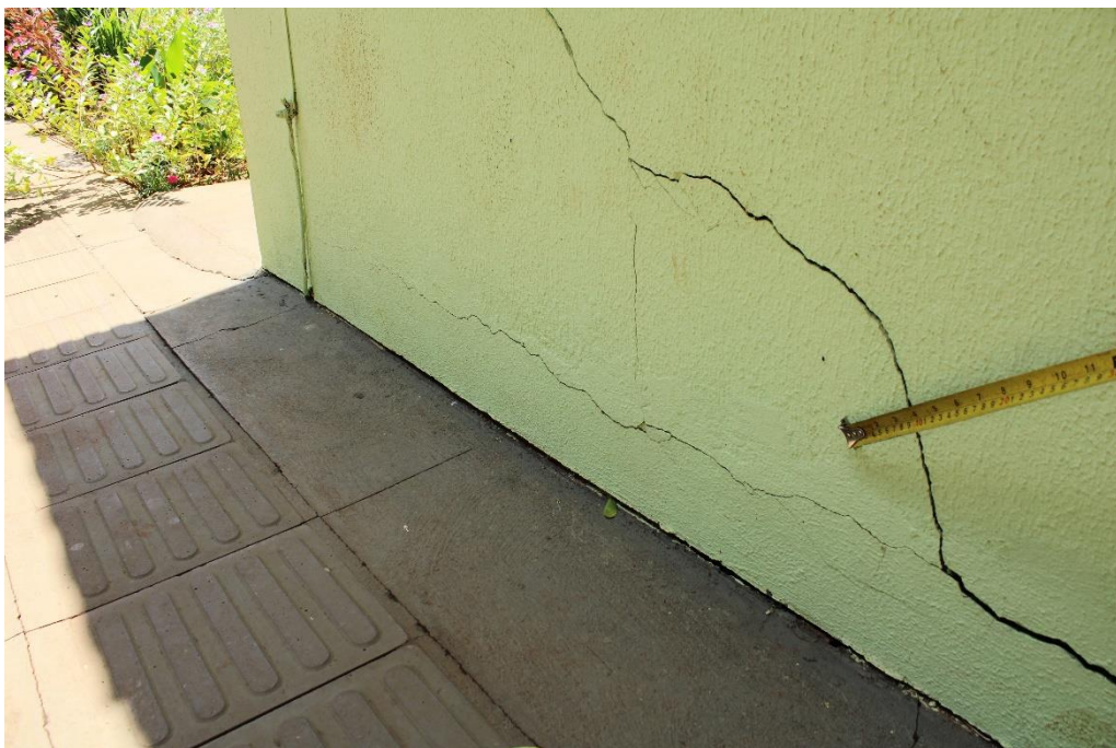
Foto nº 44. Detalhe da Foto antecessora, destacando sinais de reparos em alvenaria e trincas em alvenaria.
