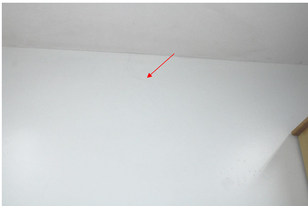
Foto nº 149. Em detalhe a Foto acima, destacando fissura em alvenaria.
