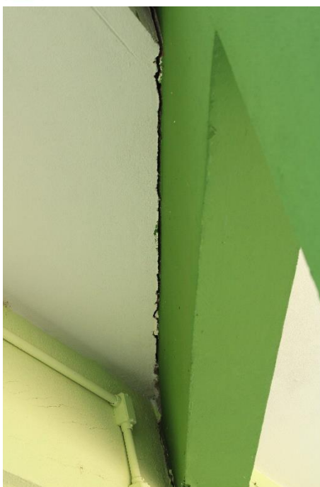
Foto nº 75. Em detalhe a Foto supra, destacando dessolidarização entre laje do beiral e elemento de concreto armado.
