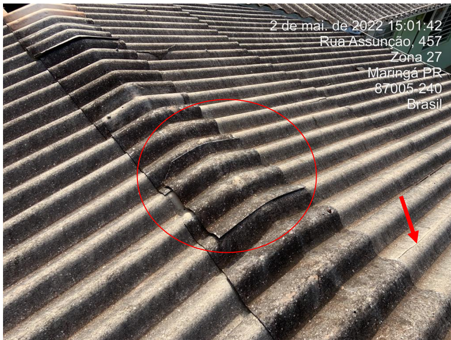
Foto nº 213. Vista parcial da cobertura sobre ampliação executada em 2015, destacando perfurações em cumeeira, ausência de fixação (parafuso) e trincas em telhas.
