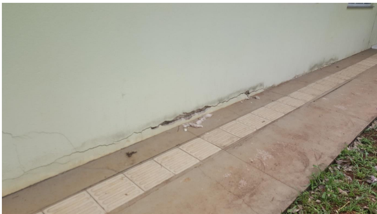
Figura 17. Vista de parede externa (região da coordenação - sala 53), ora qualificada como fachada frontal. Foto data em 29/11/2016.
