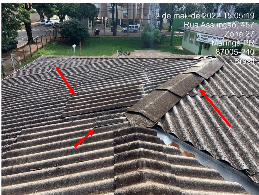
Foto nº 216. Vista parcial da cobertura do objeto do presente relatório, destacando peças do espigão soltas (sem fixação), telha sobre telha, reparos improvisados na cumeeira.
