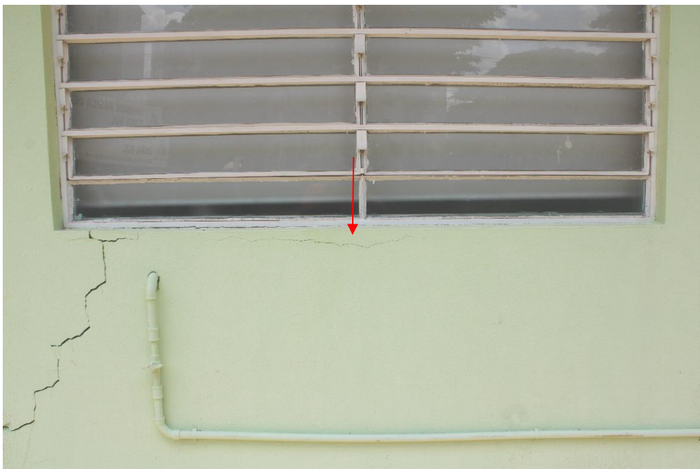
Foto nº 62. Em detalhe a Foto 57, destacando fissura horizontal sob peitoril da janela da sala 50.
