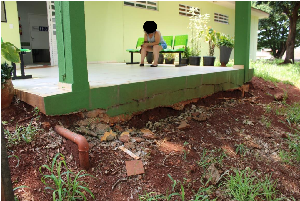
Foto nº 11. Em detalhe a Foto supra, destacando desconfinamento de solo base.
