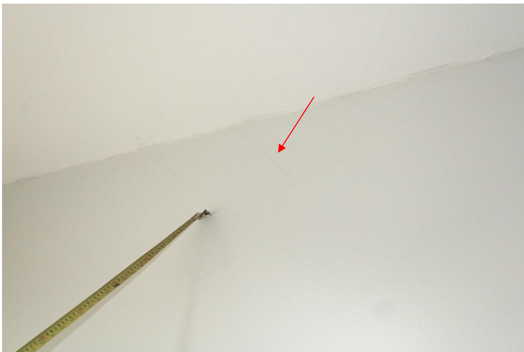
Foto nº 165. Em detalhe a Foto supra, destacando fissuras em alvenaria.
