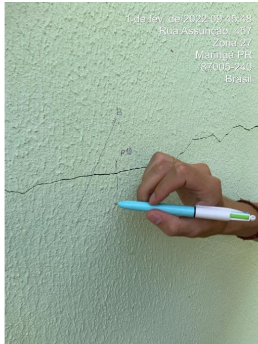
Foto nº 1. Demarcação dos pontos de aferição de aberturas de fissuras.
