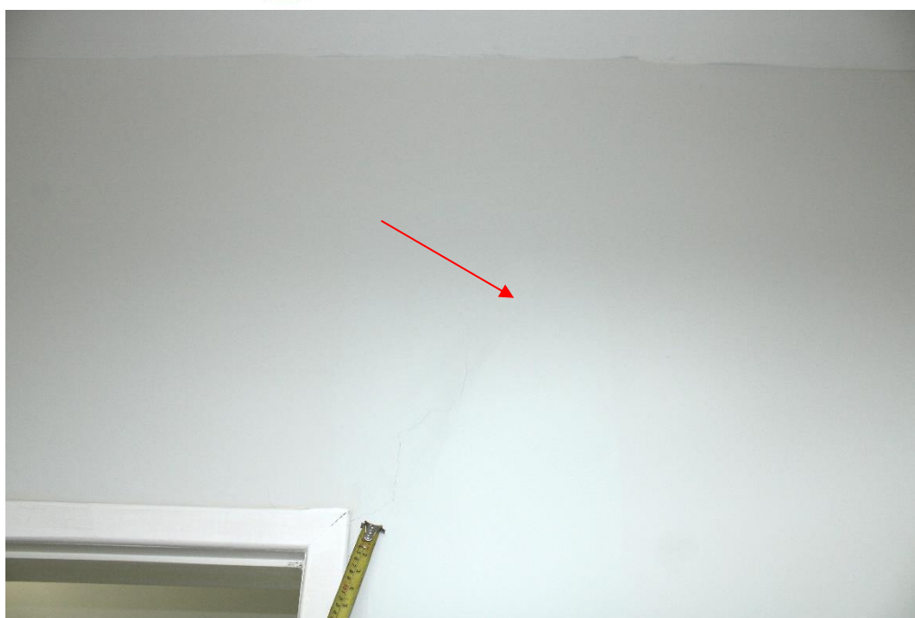
Foto nº 154. Em detalhe a Foto acima, destacando fissura diagonal com sinais de reparos primitivos.
