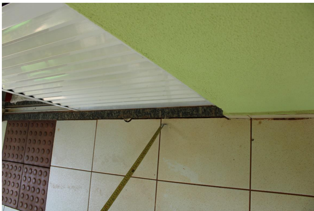
Foto nº 21. Acomodação do piso em relação a soleira em granito da porta de acesso à recepção do CTA.
