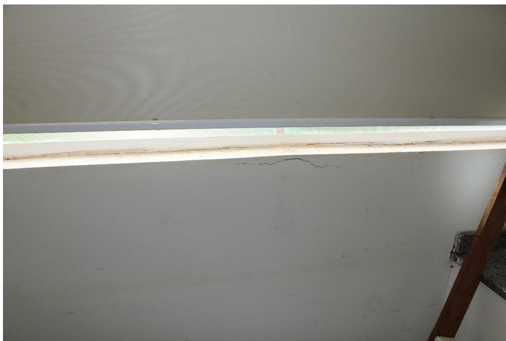
Foto nº 113. Em detalhe a foto 111, destacando fissura horizontal.
