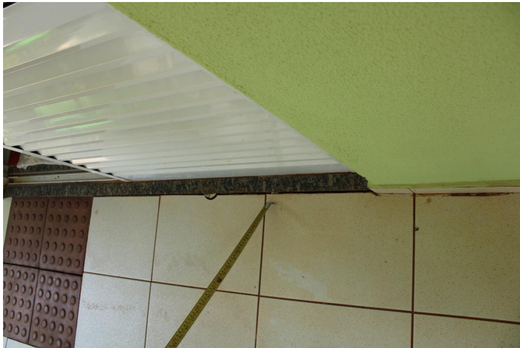
Foto nº 21. Acomodação do piso em relação a soleira em granito da porta de acesso à recepção do CTA.
