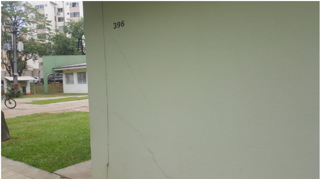
Figura 16. Vista de fissuras em parede localizada em parede externa (região da sala 53 – coordenação). Foto datada em 29/11/2016.
