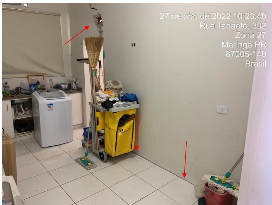
Foto nº 104. Vista parcial da sala 52, destacando acomodação do piso, bem como rachadura em alvenaria.
