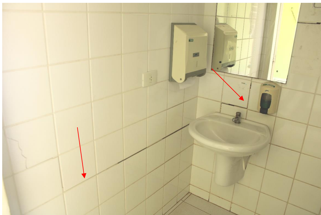
Foto nº 124. Em detalhe a Foto 124, destacando trincas diagonais e horizontal no revestimento cerâmico (azulejo).
