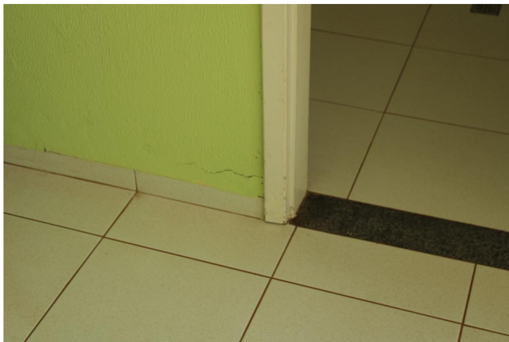
Foto nº 126. Em detalhe a foto anterior, destacando trinca horizontal, bem como sinais de reparos primitivos nessa.
