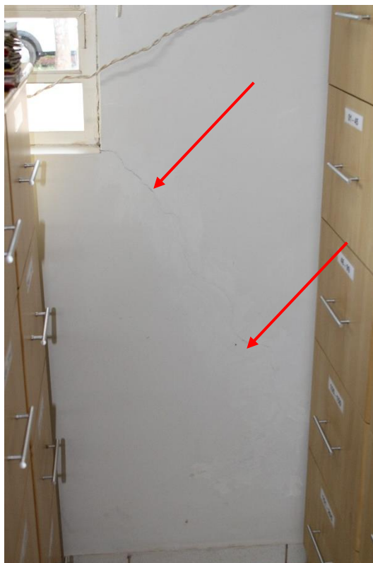
Foto nº 147. Trinca diagonal, com sinais de reparos pretéritos, em vértice inferior da janela.
