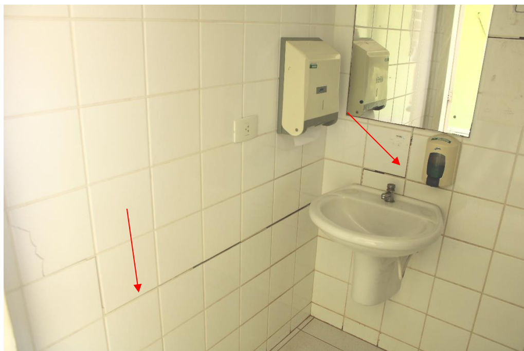
Foto nº 124. Em detalhe a Foto 124, destacando trincas diagonais e horizontal no revestimento cerâmico (azulejo).
