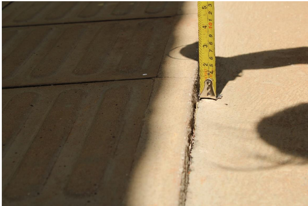
Foto nº 37. Aferição quantitativa de desnível equivalente a 3,0 centímetros.
