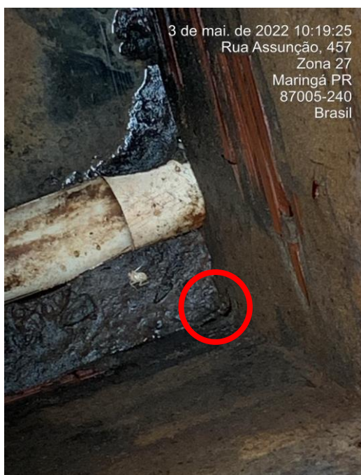
Foto nº 225. Em detalhe a Foto supra, destacando ausência de revestimento argamassado e abertura (fresta).
