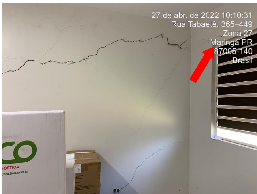
Foto nº 82. Vista parcial da sala 53, destacando trincas de conformações diagonal e horizontal em alvenaria.
