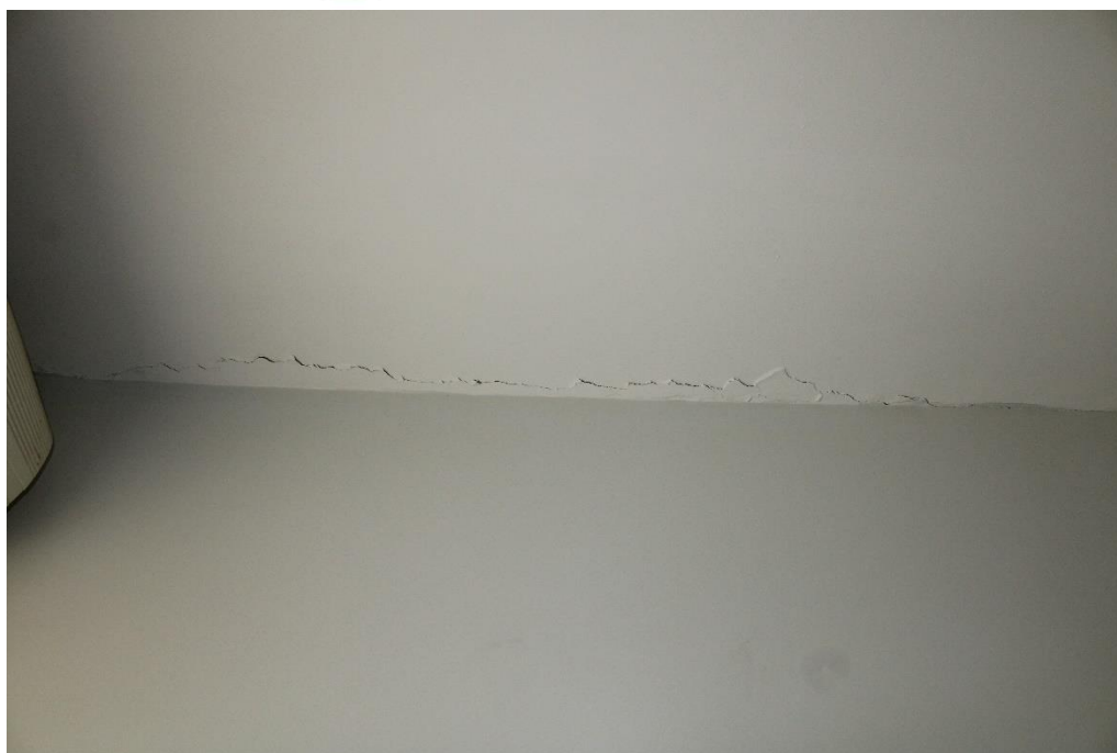
Foto nº 152. Em detalhe a Foto acima, destacando fissura em laje.
