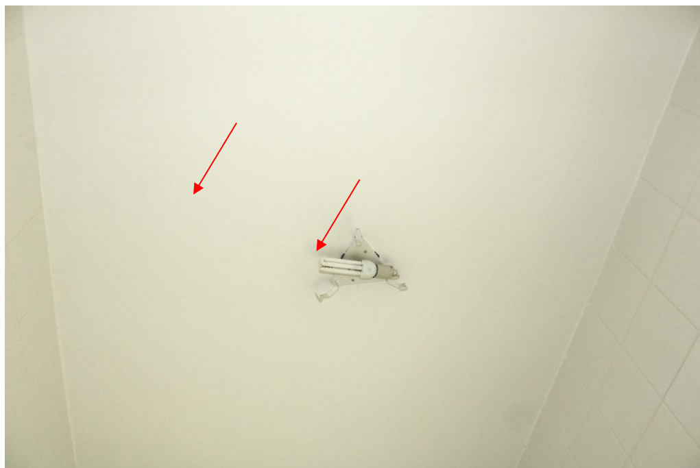
Foto nº 128. Vista da laje de teto do BWC feminino, destacando fissura em laje.
