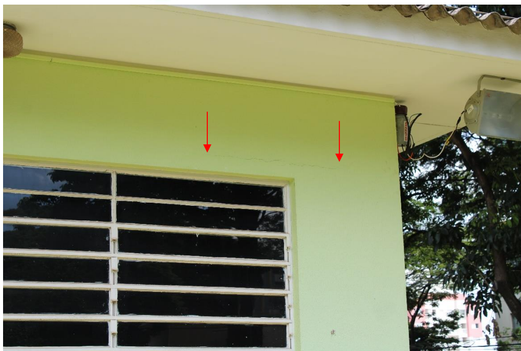
Foto nº 51. Em detalhe a Foto acima, destacando fissura horizontal sobre janela.
