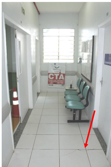
Foto nº 94. Vista parcial do corredor, destacando fissura no revestimento cerâmico (piso).
