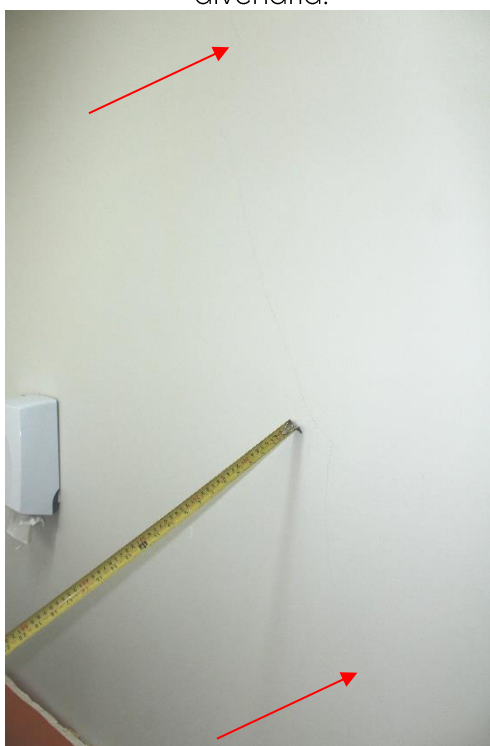
Foto nº 189. Em detalhe a Foto supra, destacando fissura diagonal.
