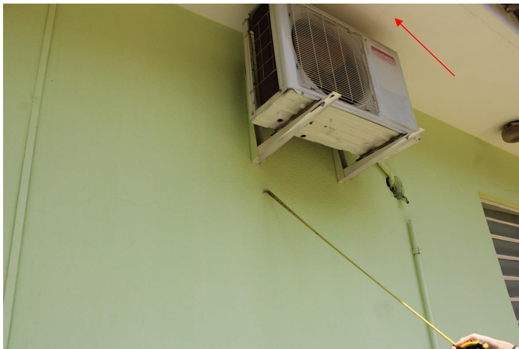
Foto nº 65. Vista de região imediatamente superior a qualificada supra, destacando fissura horizontal.
