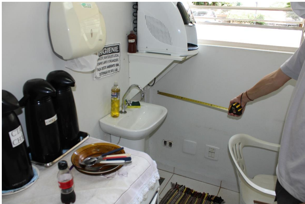
Foto nº 171. Vista parcial da sala 49, destacando fissura vertical.
