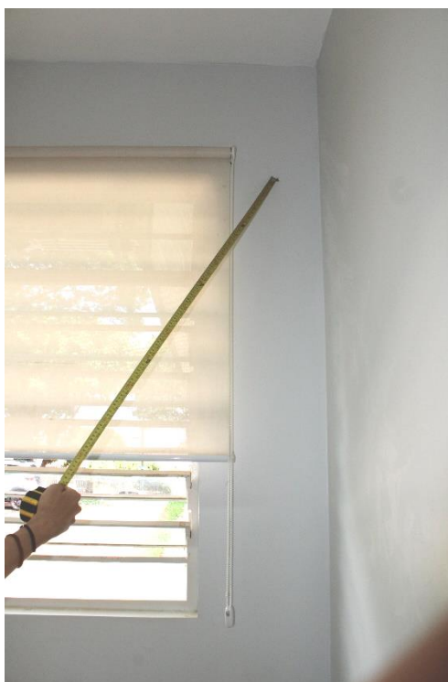
Foto nº 167. Vista parcial da sala 49, destacando fissura em vértice superior da janela.
