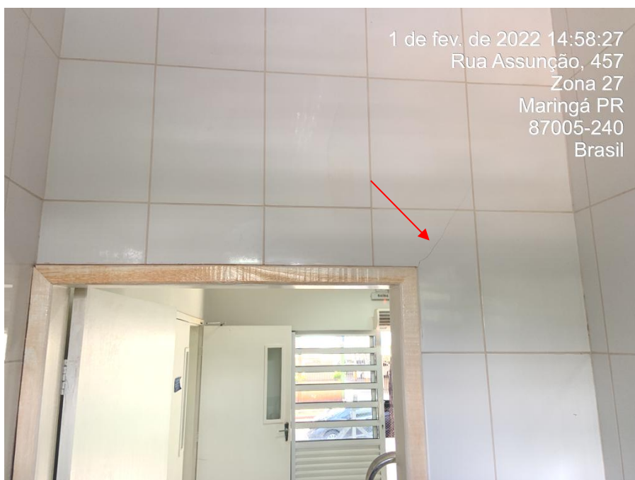
Foto nº 205. Vista parcial do BWC, destacando fissura diagonal no vértice superior da porta.
