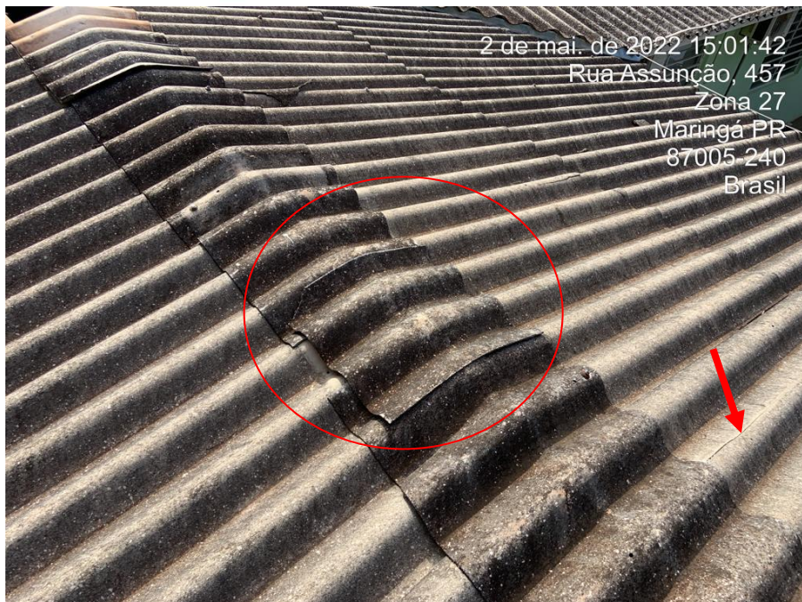
Foto nº 213. Vista parcial da cobertura sobre ampliação executada em 2015, destacando perfurações em cumeeira, ausência de fixação (parafuso) e trincas em telhas.
