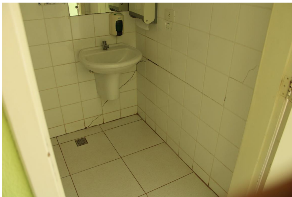
Foto nº 127. Vista parcial do BWC feminino, destacando trincas no revestimento cerâmico (azulejos).
