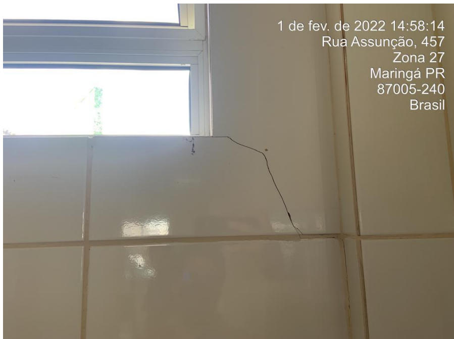
Foto nº 203. Em detalhe a Foto prévia.
