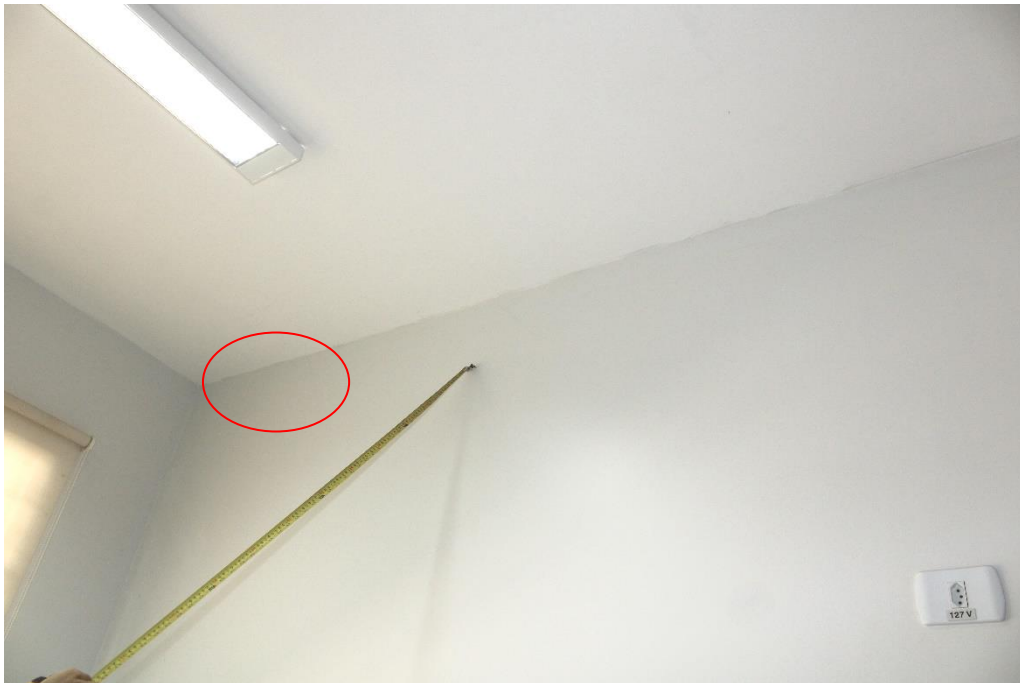
Foto nº 164. Vista parcial da sala 49, destacando fissuras em alvenaria.
