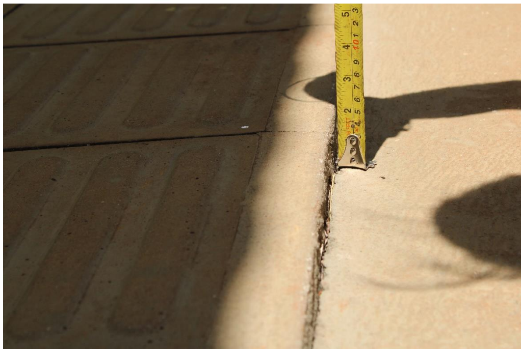
Foto nº 37. Aferição quantitativa de desnível equivalente a 3,0 centímetros.
