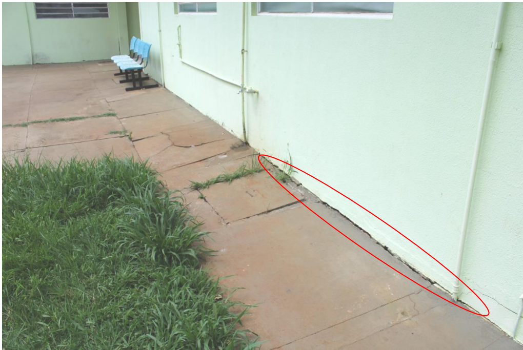
Foto nº 55. Vista parcial da Fachada Lateral Esquerda, destacando acomodação do calçamento externo em concreto desempenado, sinais de reparos na parte inferior da alvenaria, fissuras e irregularidades quanto à planicidade do calçamento.
