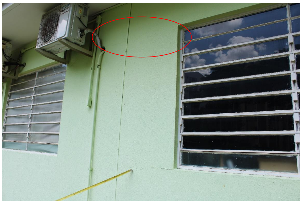
Foto nº 52. Vista parcial da Fachada Lateral Esquerda (região da coordenação – sala 53), destacando fissura de conformação horizontal em vértice inferior da janela.
