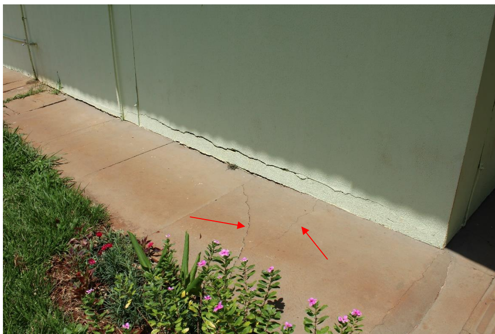
Foto nº 48. Em detalhe a Foto supra, destacando trinca horizontal em alvenaria, acomodação do calçamento externo e, ainda, fissuras no calçamento externo em concreto desempenado.
