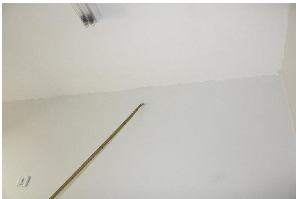
Foto nº 160. Vista parcial da copa, destacando fissura em alvenaria.
