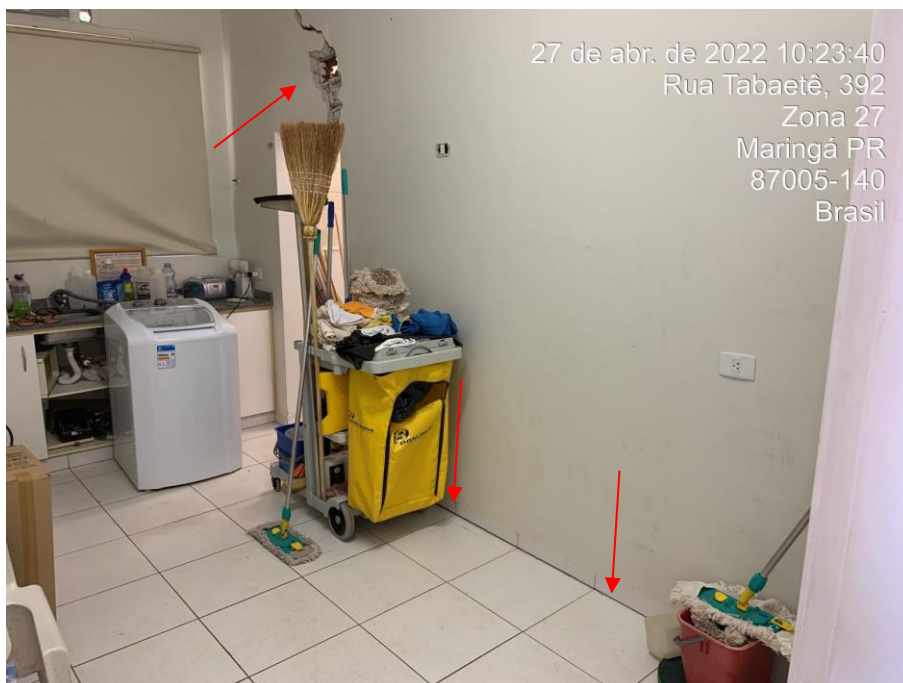
Foto nº 104. Vista parcial da sala 52, destacando acomodação do piso, bem como rachadura em alvenaria.
