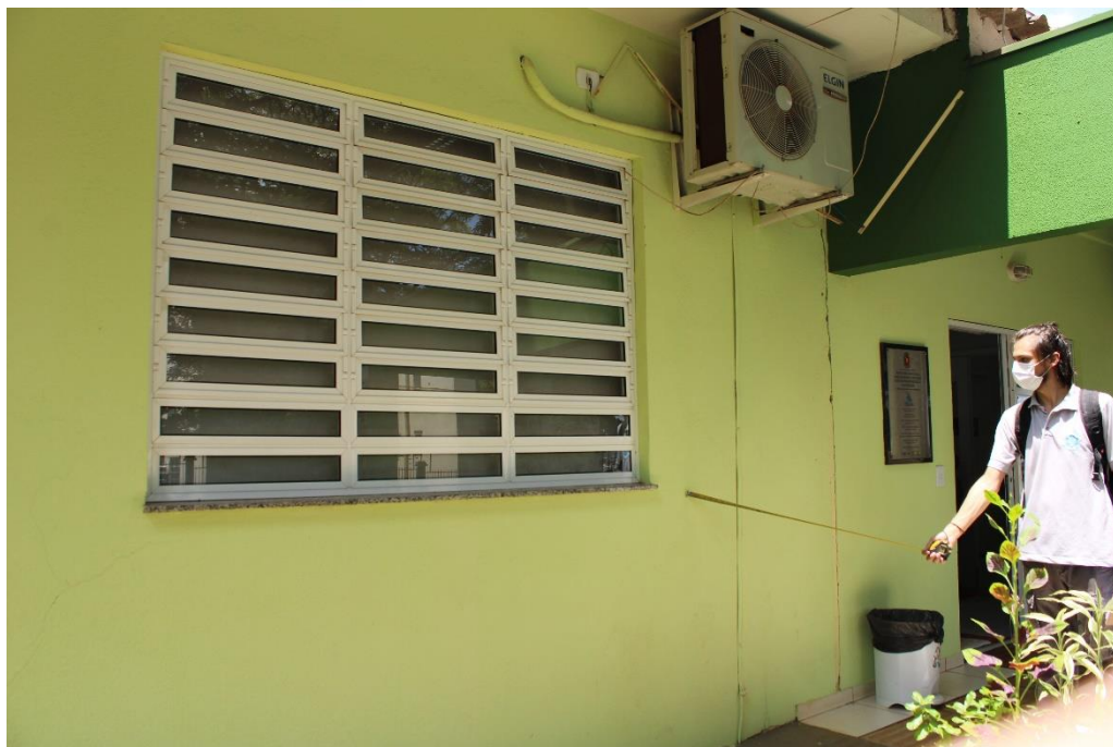
Foto nº 27. Vista parcial da fachada frontal, destacando fissura de conformação horizontal em vértice inferior da abertura.
