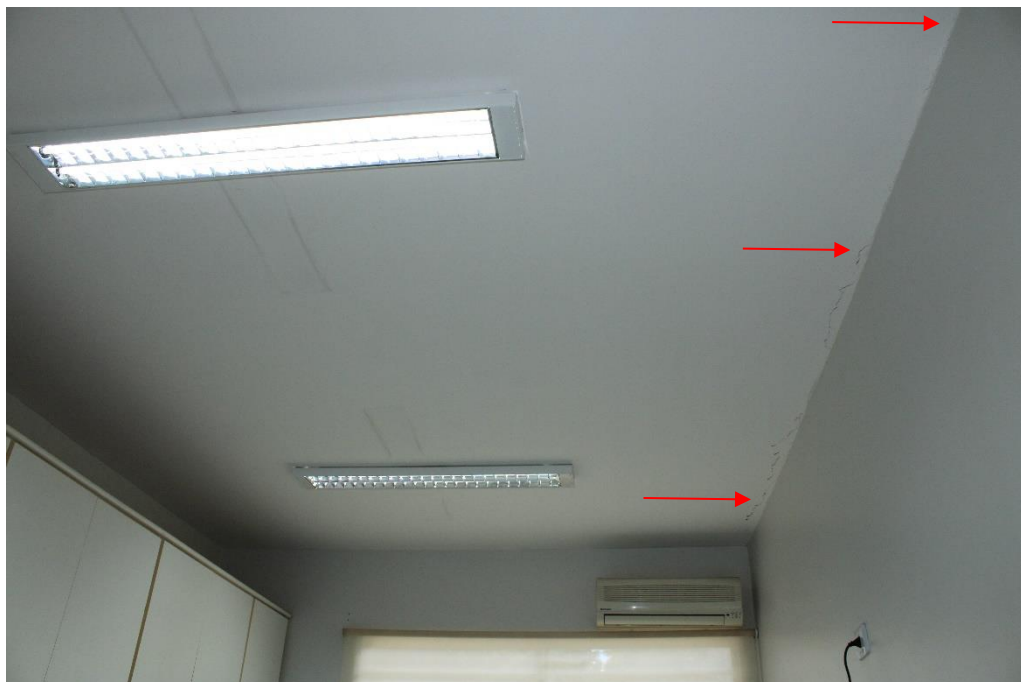
Foto nº 151. Vista da laje de teto da sala 48, destacando trinca em laje.
