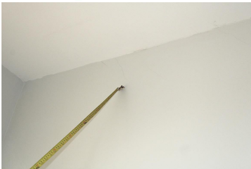
Foto nº 166. Em detalhe a Foto 164, destacando fissura em alvenaria.
