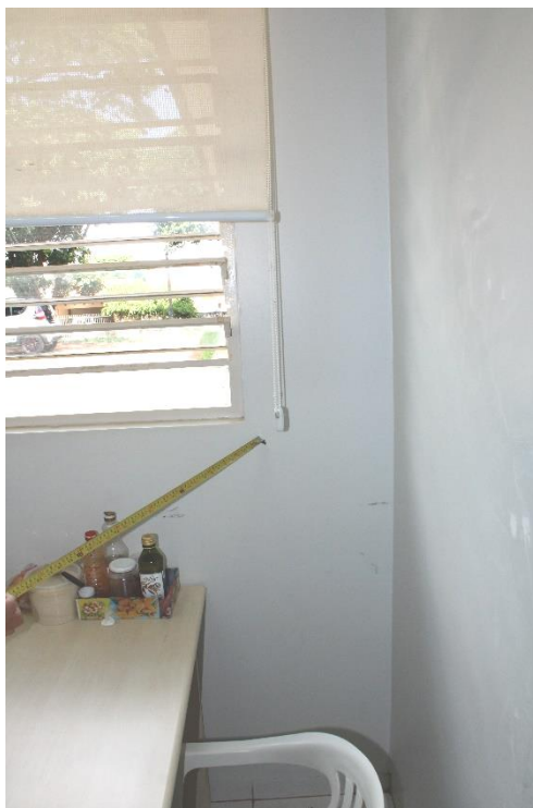
Foto nº 169. Vista parcial da sala 49, destacando fissura em vértice inferior da janela.
