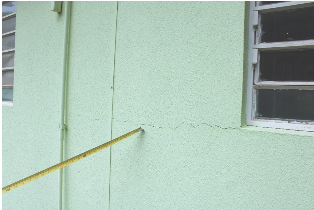
Foto nº 53. Em detalhe a Foto prévia.
