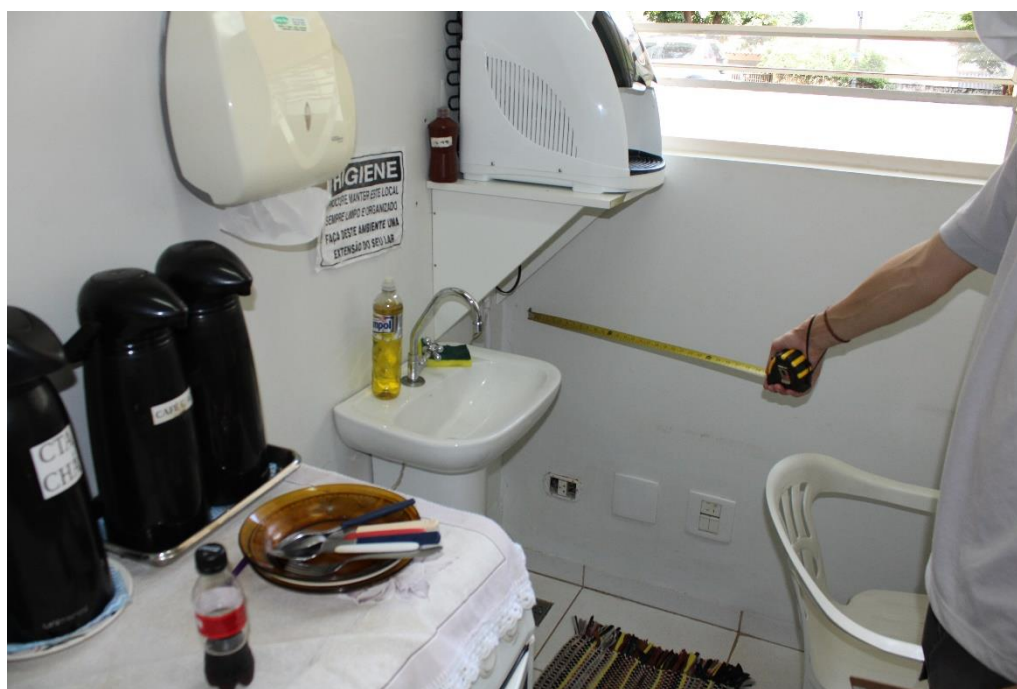
Foto nº 171. Vista parcial da sala 49, destacando fissura vertical.
