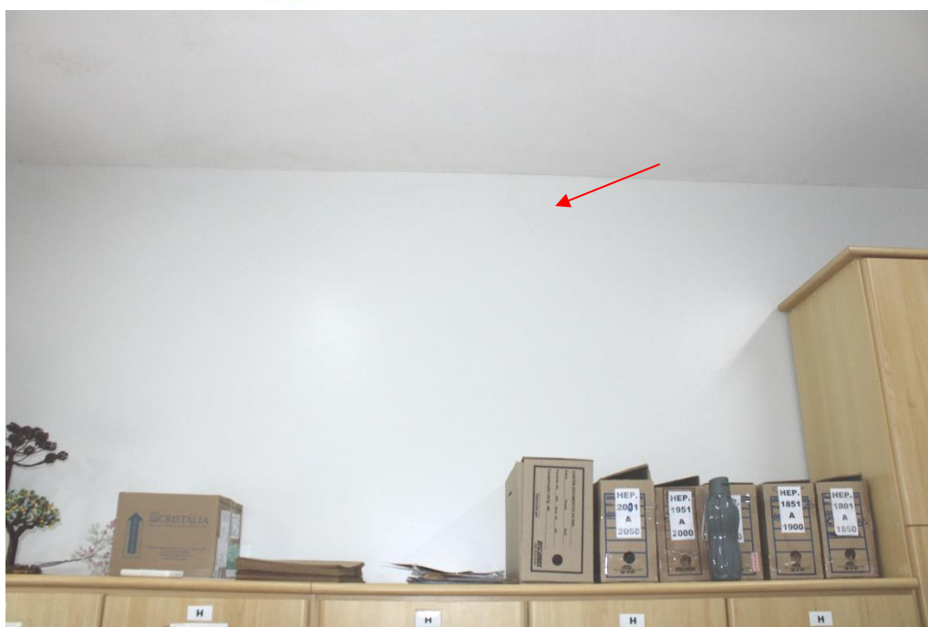
Foto nº 148. Vista parcial da sala 47, destacando fissura vertical.
