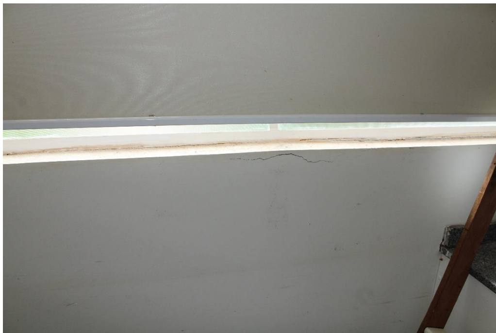
Foto nº 113. Em detalhe a foto 111, destacando fissura horizontal.
