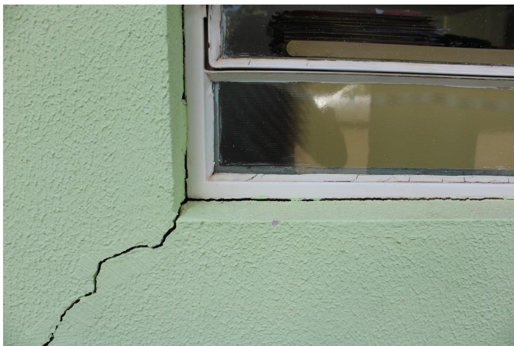
Foto nº 73. Frestas entre requadro da alvenaria e janela metálica (região da recepção).
