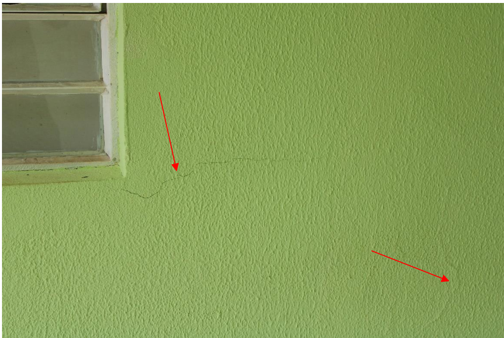
Foto nº 134. Em detalhe a Foto 133, destacando fissura horizontal em vértice inferior de janela, bem como sinais de corrosão de fissura em alvenaria.
