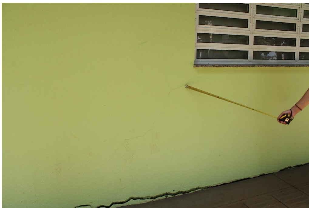
Foto nº 33. Vista parcial da Fachada Frontal (região entre corredor e coordenação – sala 53), destacando fissura de conformação diagonal em vértice inferior de janela.
