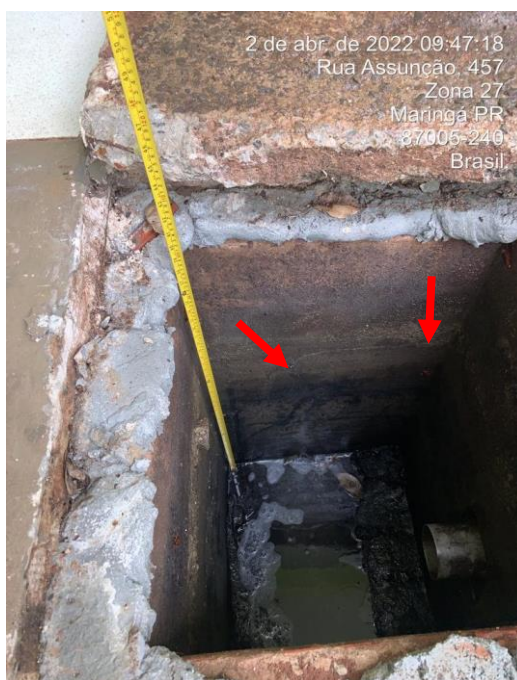
Foto nº 224. Vista da CE3, destacando fissura.
