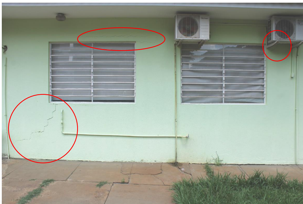
Foto nº 57. Vista parcial da Fachada Lateral Esquerda (região das salas 50 e 52).
