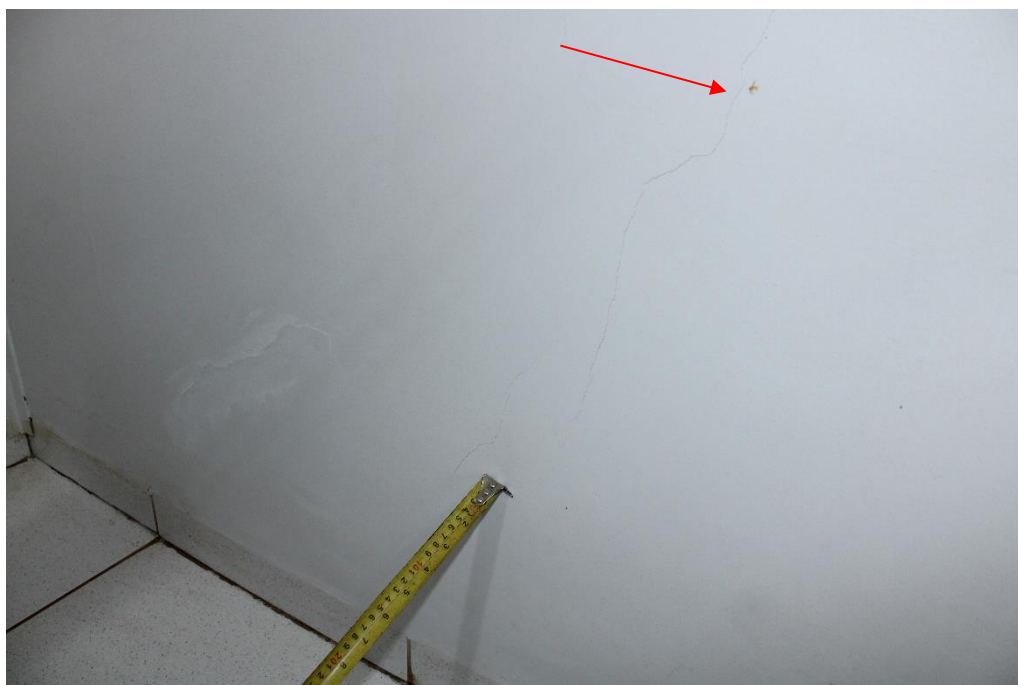
Foto nº 141. Vista parcial da sala 47, destacando fissura em alvenaria.
