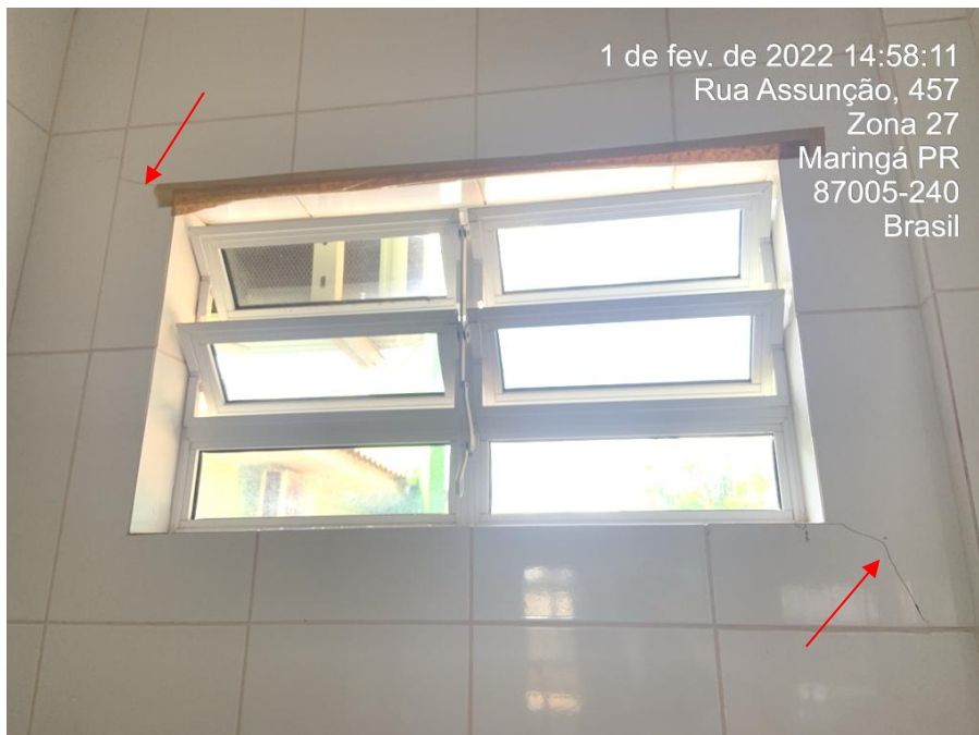
Foto nº 202. Fissuras no revestimento cerâmico (azulejos) em vértices da janela.
