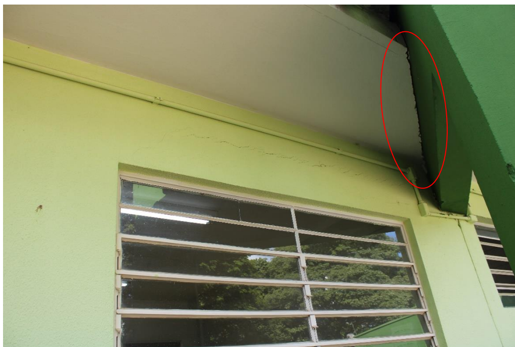
Foto nº 74. Em detalhe a Foto 70, destacando trinca horizontal sobre janela (região da recepção).
