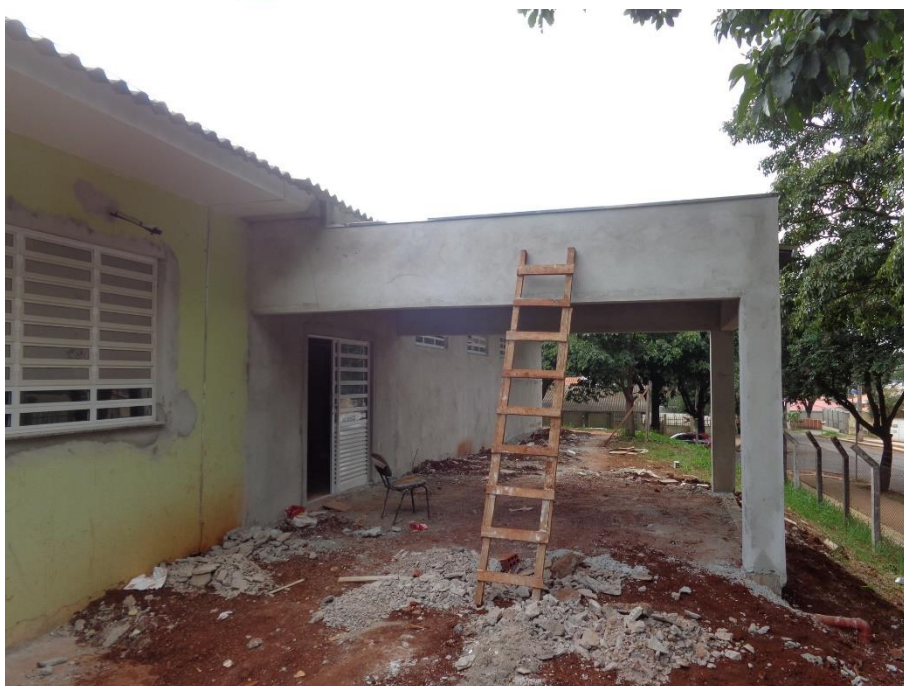
Figura 9. Registro Técnico Fotográfico encaminhado pelo Eng. Civil Rafael, já qualificado, da obra de ampliação da Policlínica (2014/2015).
