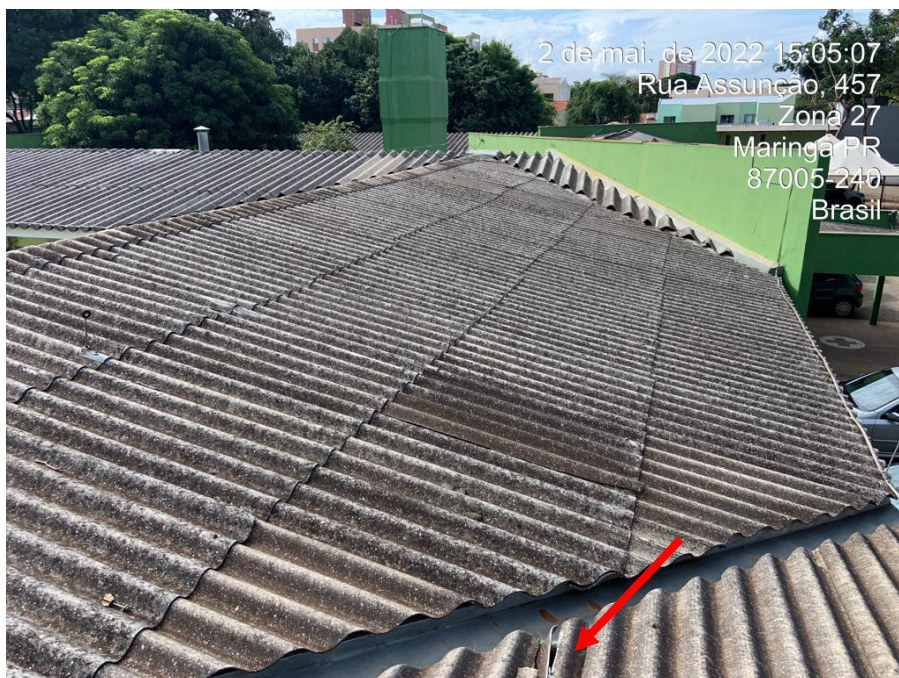
Foto nº 214. Vista parcial da cobertura sobre objeto do presente relatório, destacando telhas quebradas.
