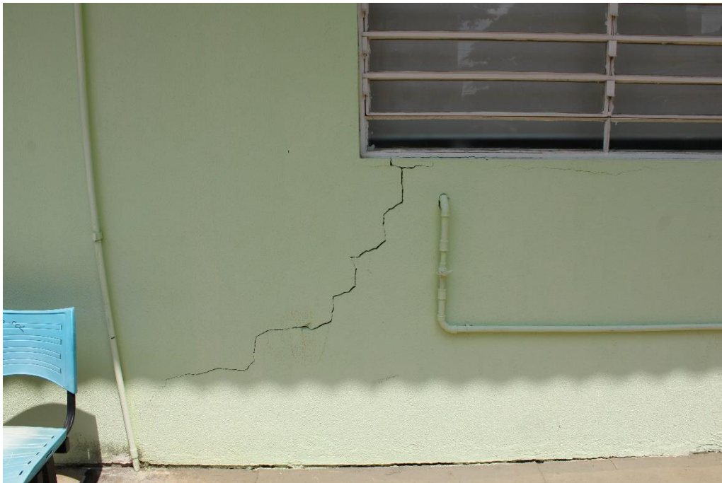
Foto nº 61. Em detalhe a Foto 57, destacando trinca de conformação diagonal em vértice inferior da janela da sala 50, visualizada externamente, bem como fissura horizontal sob peitoril dessa.
