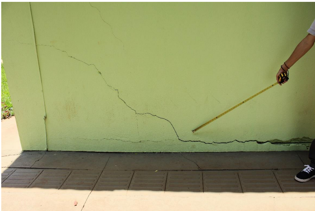
Foto nº 42. Sinais de reparos em alvenarias, na região circundante de fissura/trinca de conformação horizontal.
