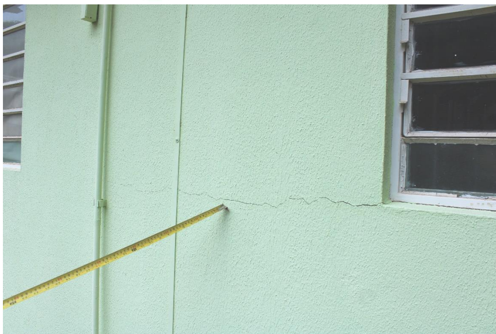
Foto nº 53. Em detalhe a Foto prévia.
