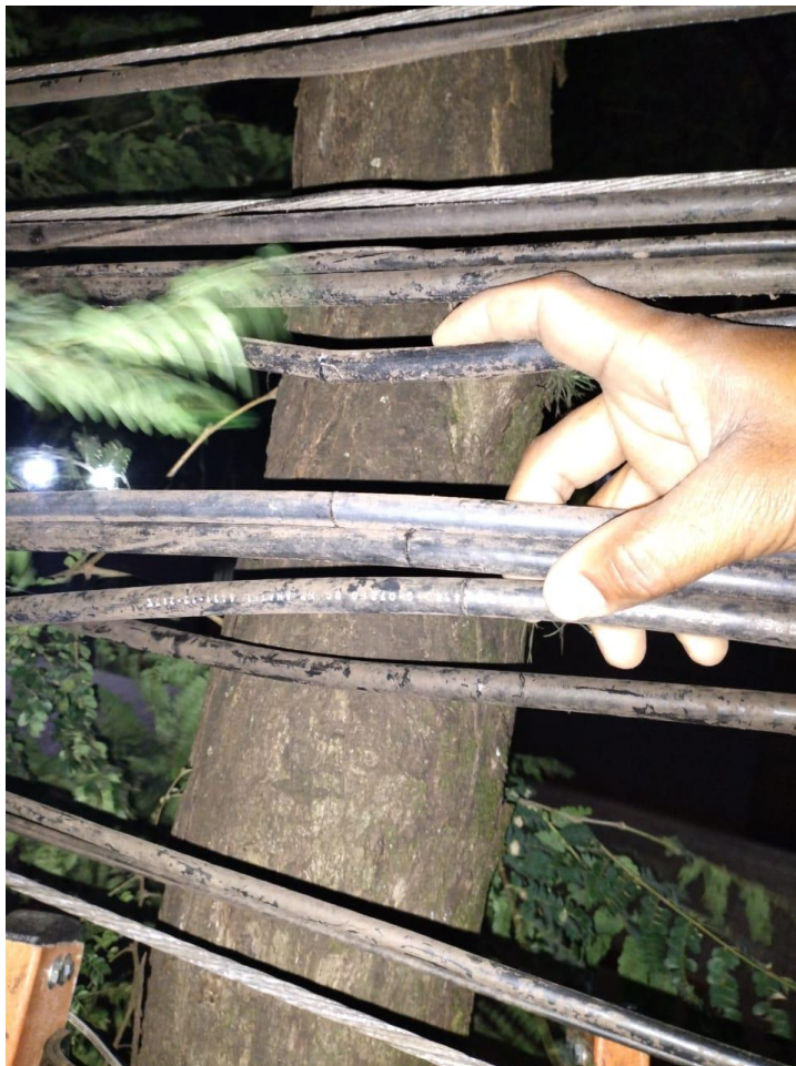
Evidência do 1º ponto do rompimento.
