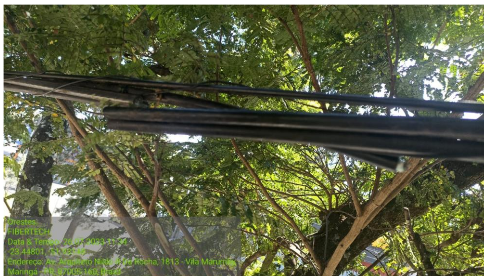
Evidência do 2º ponto do rompimento.
