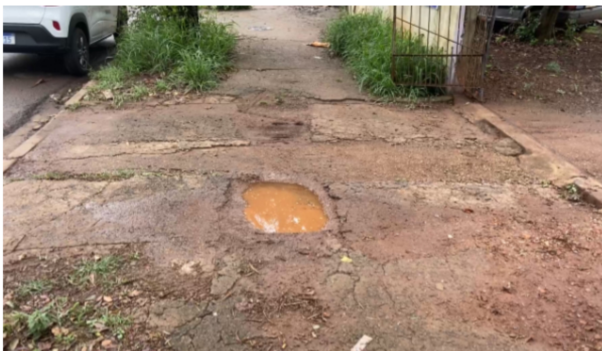
Figura 11 – Calçada de lote particular, no lado oposto ao do objeto na Rua Dr. Lafaiete Tourinho
